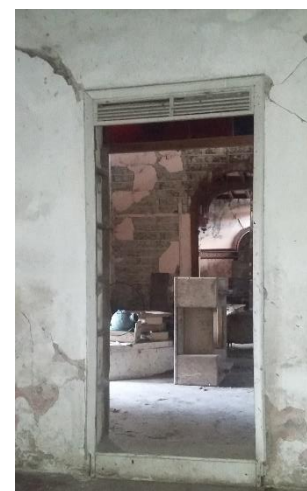
Imagen 34. Grietas en vanos de puertas. Tomada por Jéssica Gavidia en Julio 2016
