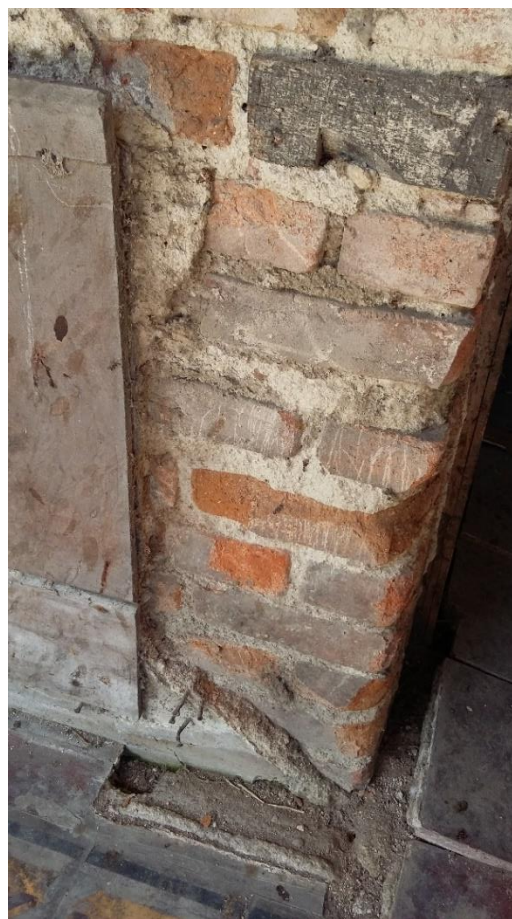
Imagen 4 y 5. Muros de Tabique interiores con mortero cal-arena. Fuente: Tomada por Jéssica Gavidia en Enero 2017
