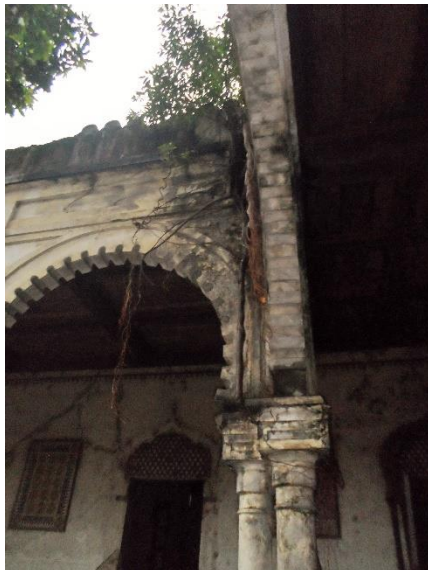
Imagen 33. Deterioro arcos en corredor interior. Tomada por Jéssica Gavidia en Agosto 2016.
