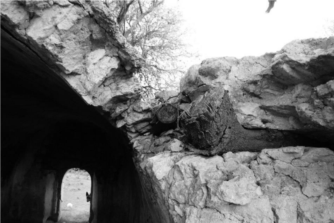
Imagen 3. Sutñ'u, Patria Nueva. Crecimiento de vegetación en la estructura del inmueble.
