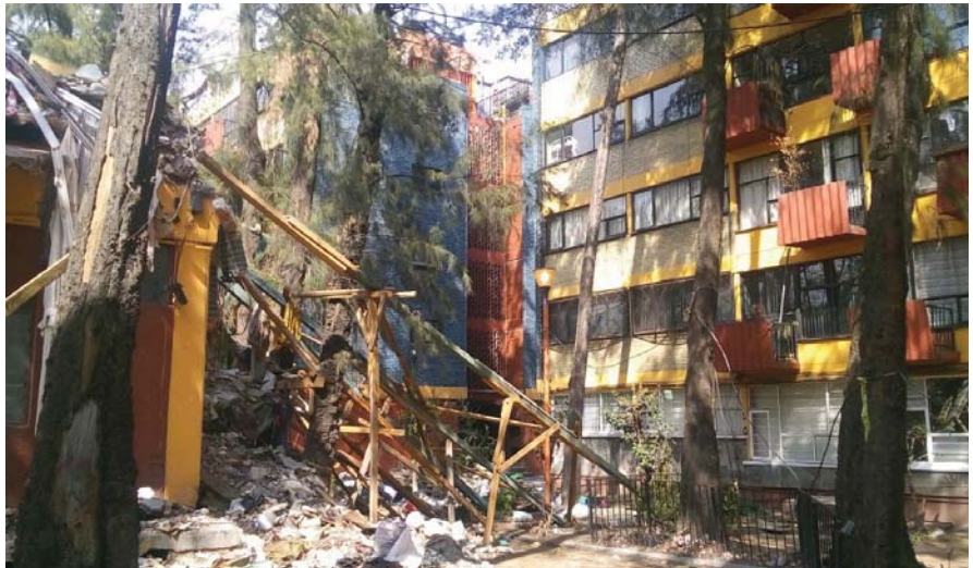
Imagen 29. Edificio del multifamiliar colapsado por el sismo.
