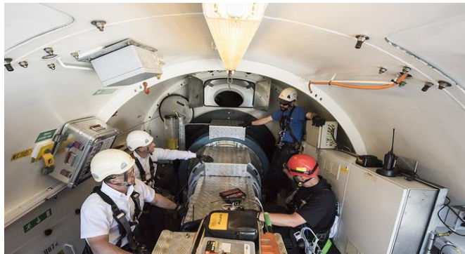
Figura 9.4: Dentro de la góndola de un aerogenerador de 2.3 MW, EUA. Fuente: National Renewable Energy Lab, 2017.
