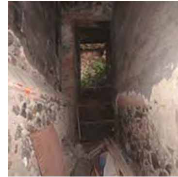
Foto No. 29. (7). Pasillo que comunica patio principal al segundo patio. Sobre este se encuentran vanos clausurados correspondientes al semisótano, el segundo patio tiene escaleras que conducen al ala norte y ala sur. Este patio se encuentra semiderruido y lleno de escombros (Ruiz, 2016)
