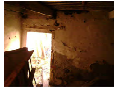
Foto No. 32. (3). Interior de primer nivel. Al igual que en el exterior, presenta un alto deterioro en sus aplanados y en general en todos sus elementos. Las puertas son de madera, los vanos tienen derrames y algunas habitaciones contaban con cielorraso (Desconocido, s.f.).
