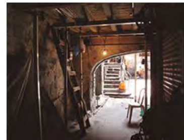
Foto No. 24. (2). Accesos al inmueble. La entrada del inmueble se encuentra reducida por un local, el pasillo que comunica la calle con el interior del inmueble tiene un entrepiso de terrado y muros de piedra (Ruiz, 2016).
