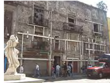
Foto No. 23. (1). Fachada. Su fachada es de estilo barroco, ha perdido el aplanado en su totalidad, cuenta con herrería en hierro forjado en balcones, las puertas y ventanas son de madera y con cortinas metálicas en las accesorias (Ruiz, 2016).
