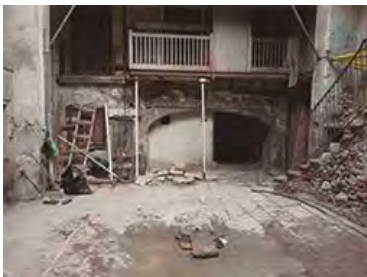
Foto No. 28. (6). Patio principal y acceso principal. Presenta pérdida de aplanados en muros y pilastra. Los muros son principalmente de tezontle y piedra braza, y en menor grado tabique rojo, utilizado probablemente para las adecuaciones y reforzamientos posteriores. (Ruiz, 2016)
