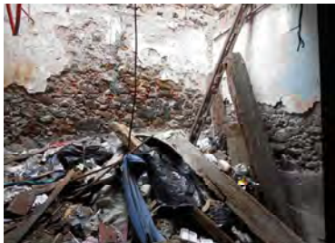
Foto No. 36. (7). Habitaciones Sureste. Se aprecia la composición del muros de piedra braza y tezontle, el desplome del entrepiso a base del sistema terrado, por la acumulación de basura y falta de mantenimiento (Ruiz, 2016).
