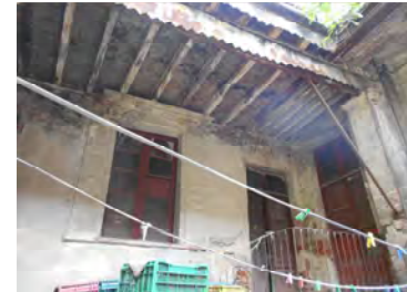
Foto No. 31. (2). Fachada Este. Su uso original fue habitacional, aunque también llegó a tener un uso comercial, aun cuenta con algunas cortinas metálicas. Presenta deterioro y pérdida parcial y total de aplanados, por falta de mantenimiento (Ruiz, 2016).
