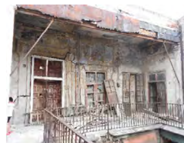
Foto No. 43. (7). Ala Oeste. Esta ala presenta diversas fisuras en muros y vanos, los enmarcamientos son de cantera, estas puertas cuentan con entablado y postigos de madera. La gualdra descansa sobre pilastras, reforzada con una viga y ménsulas metálicas, cubierta con un faldón de lámina metálica.
