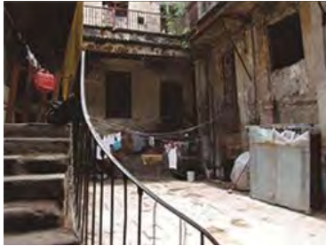
Foto No. 25. (3). Patio principal. El patio principal es de forma rectangular, este funciona como el enlace entre todos los diversos espacios. El piso es de cantera de 35x70 cm (Ruiz, 2016)
