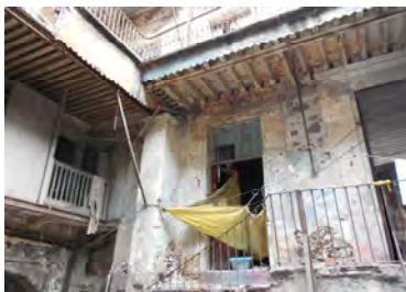
Foto No. 30. (1). Fachada Noroeste. Barandal de madera y un 1/2 baño de lámina agregados a la fachada Este. Barandal de hierro forjado, pilastra adosada para sostener pasillos de planta 2. a piso y muros predominantemente de piedra braza y tezontle (Ruiz, 2016).
