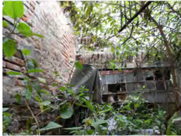
Foto No. 35. (6). Patio posterior ala Este. En un tiempo este patio alojó un local de servicio sanitario que fue clausurado. Es tal el abandono y acumulaciones de escombros que han crecido diversas plantas, algunas de ellas alcanzando el según piso. (Ruiz, 2016).
