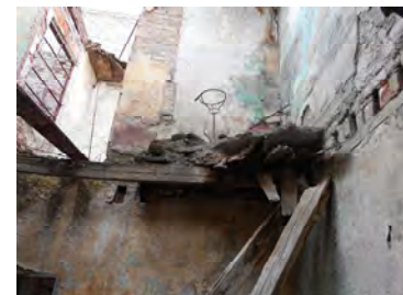
Foto No. 34. (5). Habitaciones ala Noreste. Presenta el desplome de sus techumbres por la falta de mantenimiento y la acumulación de basura, la cual es arrojada de las vecindades colindantes. (Ruiz, 2016).
