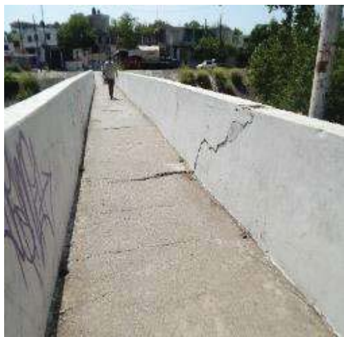
a) Puente peatonal agrietado en losa y barandales
