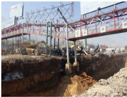
Las obras de un paso a desnivel en la zona provocaron el reblandecimiento (Leonel Rocha)
