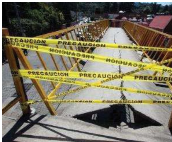
b) Puente inhabilitado por fractura en la losa
