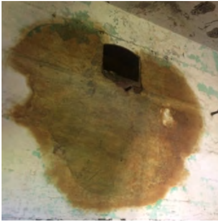
Figura 49 Muro de la sección de hilados con presencia de mancha de grasa.
