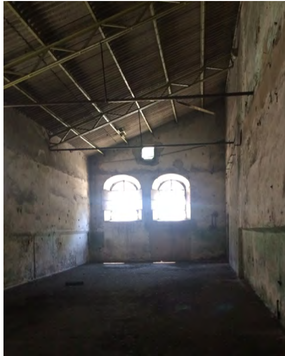
Figura 40 Sistema de cubiertas a base de lámina de asbesto con soporte de hierro
