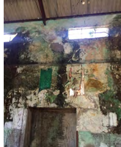
Figura 48 Muro de sección de hilados con presencia de humedades, raíces y flora.
