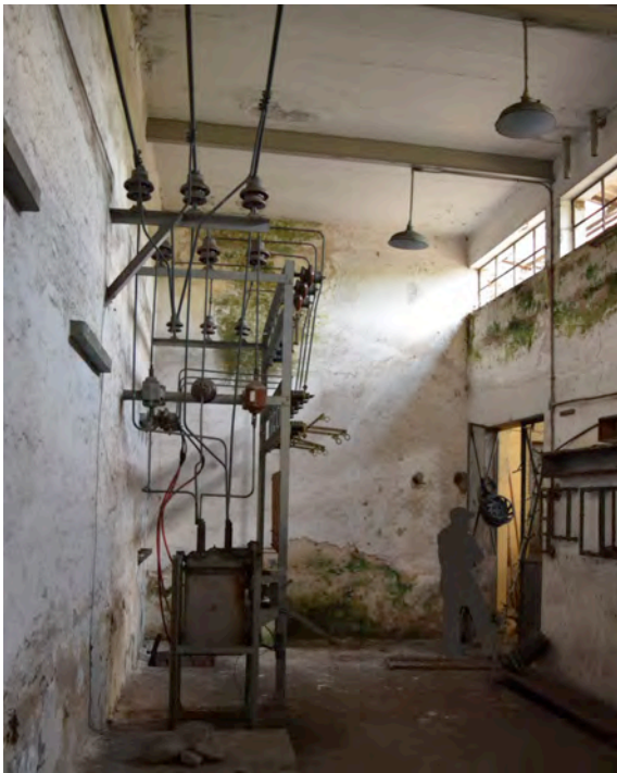
Figura 22 Subestación eléctrica dentro de la antigua fábrica de hilados y tejidos La Purísima. (Fotografía propia)
