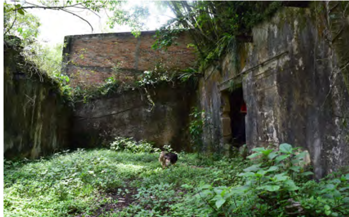
Figura 50 Área con losa colapsada e invasión de flora
