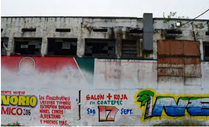
Figura 47 Muro de fachada con presencia de publicidad y grafiti, deterioro en herreía por presencia de oxido en puerta y ventanas además del faltante de vidrios en ventanas, presencia de humedades y flora intrusiva
