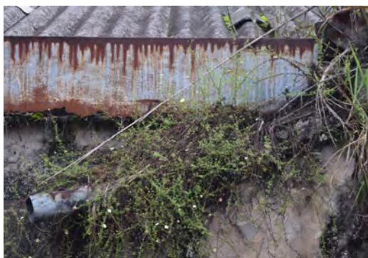
Figura 51 Flora intrusiva en canal de agua pluvial de la cubierta de lámina de asbesto en la sección de hilados
