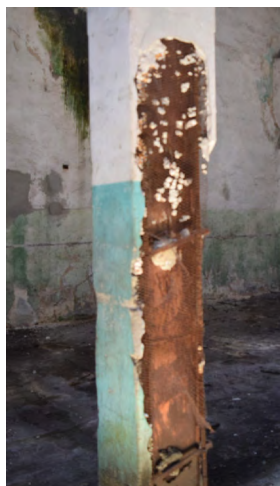
Figura 52 Columna metálica con presencia de oxido y perdida de aplanado
