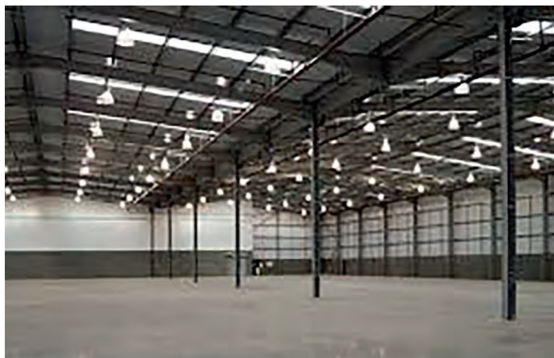
[Fig. 132] Ejemplo de alumbrado en un almacén industrial.
