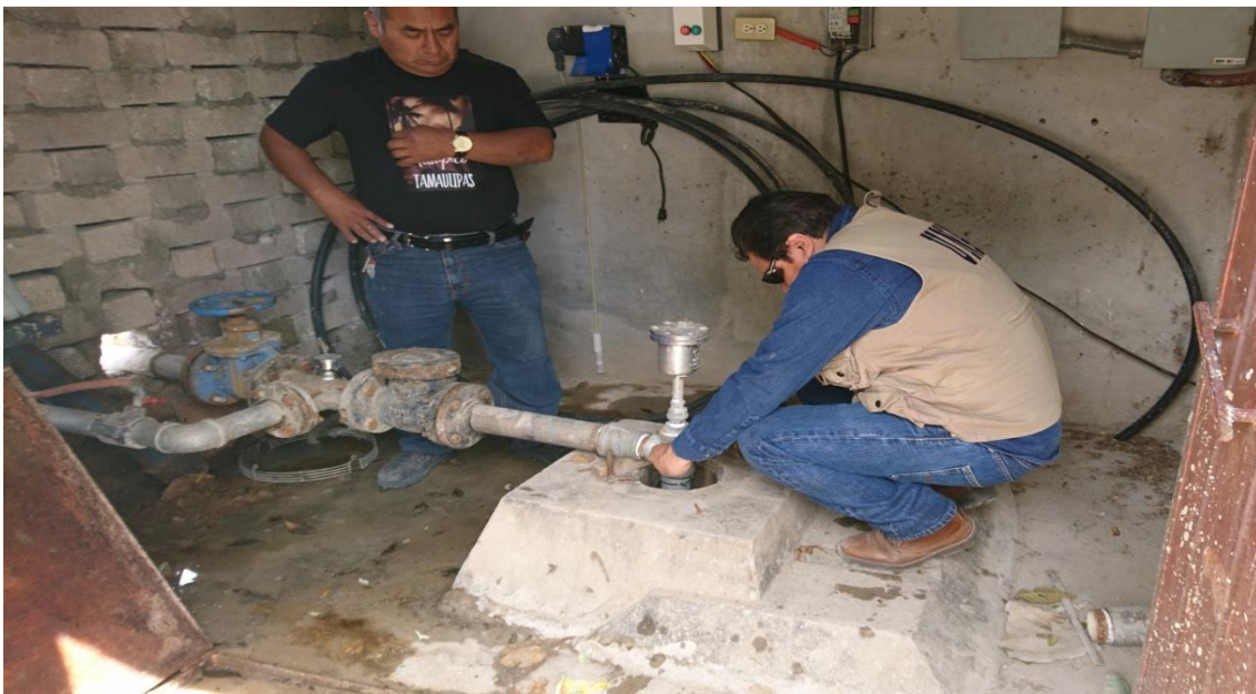
Fotografía. 7. Equipo de bombeo para pozo. LCB 2018, fotografía tomada por la brigada de trabajo.
