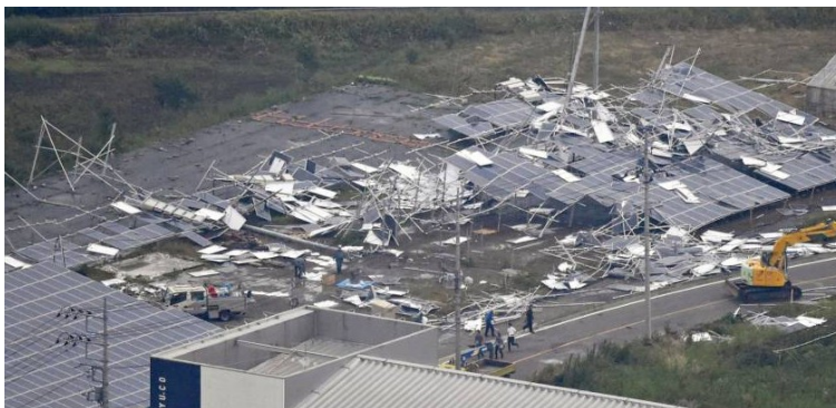
Figura 1. SFV arrasado por la acción del viento mostrando la debilidad de la estructura. Por The Japan Times News, 2015. Recuperado de https://www.japantimes.co.jp/news/2015/06/16/national/wild-winds-cause-damage-injury-gunma/#.W6UXGB8xBSU . Copyright THE JAPAN TIMES LTD.
