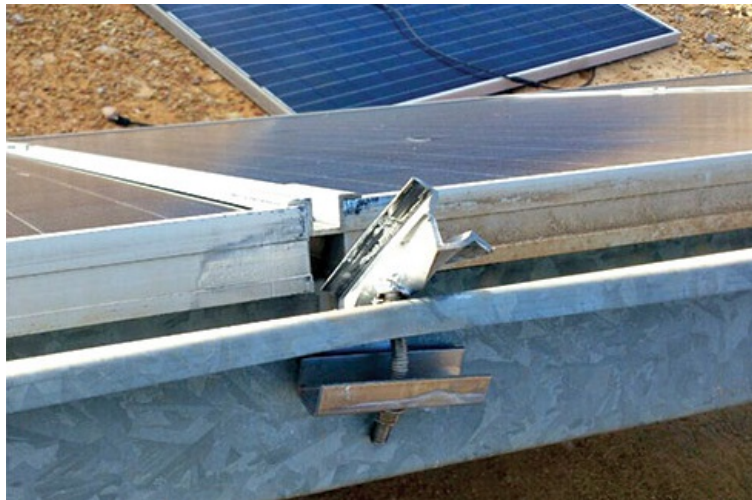
Figura 74. Daño causado en un grapa ocasionado por la acción del viento debido a un mala caracterización del las cargas por viento. En " Designing PV Systems for Environmental Extremes ", por David Brearley, 2015. Retomado de https://solarprofessional.com/articles/design-installation/designing-pv-systems-for-environmental-extremes.W8DgDvaZLIU . Copyright [2018] Home Power Inc.
