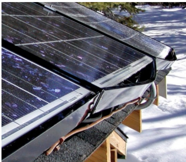
Figura 64. Marcos de módulos fotovoltaicos deformados. Sin apoyo, el vidrio en el módulo más alejado se rompió bajo el peso de la nieve. En “Designing PV Systems for Environmental Extremes” , por David Brearley, 2015. Retomado de https://solarprofessional.com/articles/design-installation/designing-pv-systems-for-environmental-extremes.W8DgDvaZLIU . Copyright [2018] Home Power Inc.
