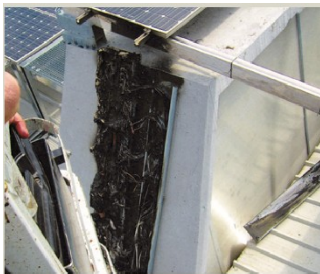
Figura 47. Incendio de una caja de conexiones de potencia fotovoltaica como resultado de uniones deficientes. En “PV electrical plants fire risk assessment and mitigation according to the Italian national fire services guidelines” , por Piergiacomo Cancelliere, 2016. FIRE AND MATERIALS, Vol. 40, p. 356. Copyright [2014] John Wiley Sons, Ltd.
