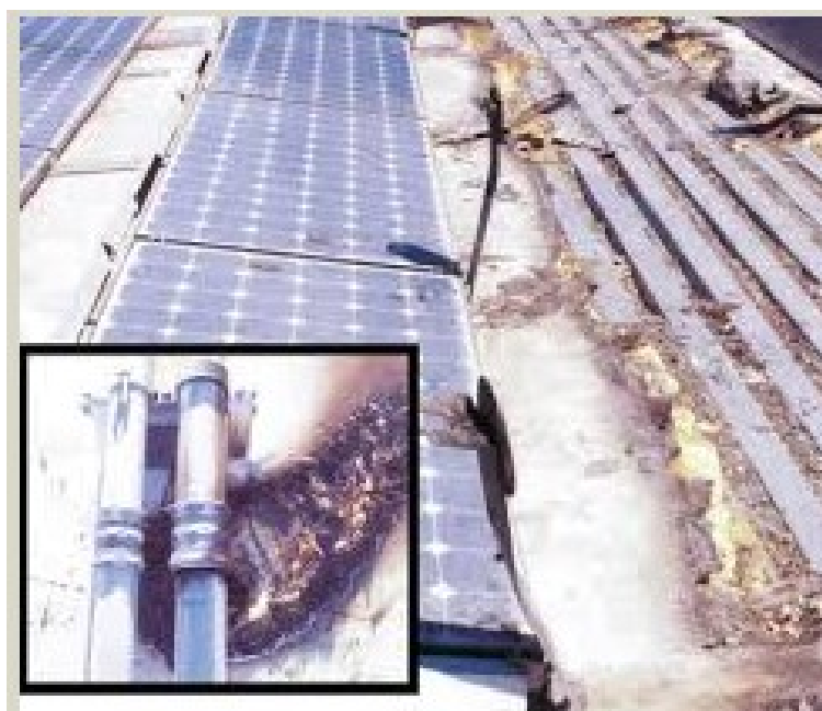
Figura 7. Punto de origen y consecuencias del incendio en tienda minorista. En “The Bakersfield Fire: A Lesson in Ground-Fault Protection” , por Bill Brooks, 2009. Retomado de https://solarprofessional.com/articles/design-installation/the-bakersfield-fire-a-lesson-in-ground-fault-protection.W6xaU_aZLIV . Copyright [2018] Home Power Inc
