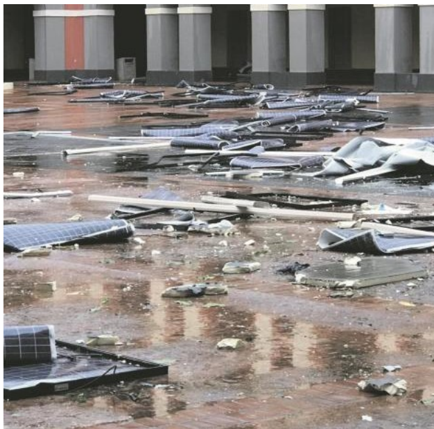
Figura 20. Los módulos fotovoltaicos de la azotea del Cuartel de Ballajá quedaron esparcidas por el patio del edificio. Cortesía Carlos Rubio Cancela.
