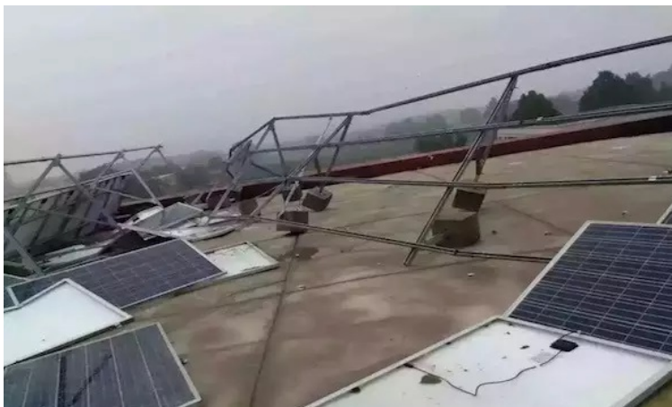
Figura 71. Deslizamiento de la estructura fotovoltaica fijada con lastres debido a la acción del viento. En “How to avoid the typhoon solar bracket system fly?” , por Chiko Solar Technology, 2017. Retomado de http://www.chikolar.com/news/industry/111.html . Copyright [2018-2017] Shanghai Chiko Solar Technology Co.
