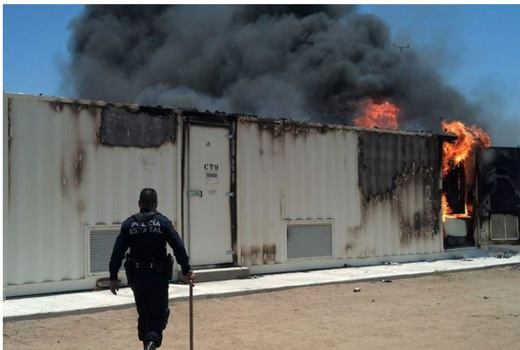
Figura 11. Incendio en un Centro de Transformación (CT) de la planta Aura Solar. En BCS NOTICIAS. Recuperado de http://www.bcsnoticias.mx/incendio-afecto-planta-aura-solar/ . Copyright [2018] BCS Noticias
