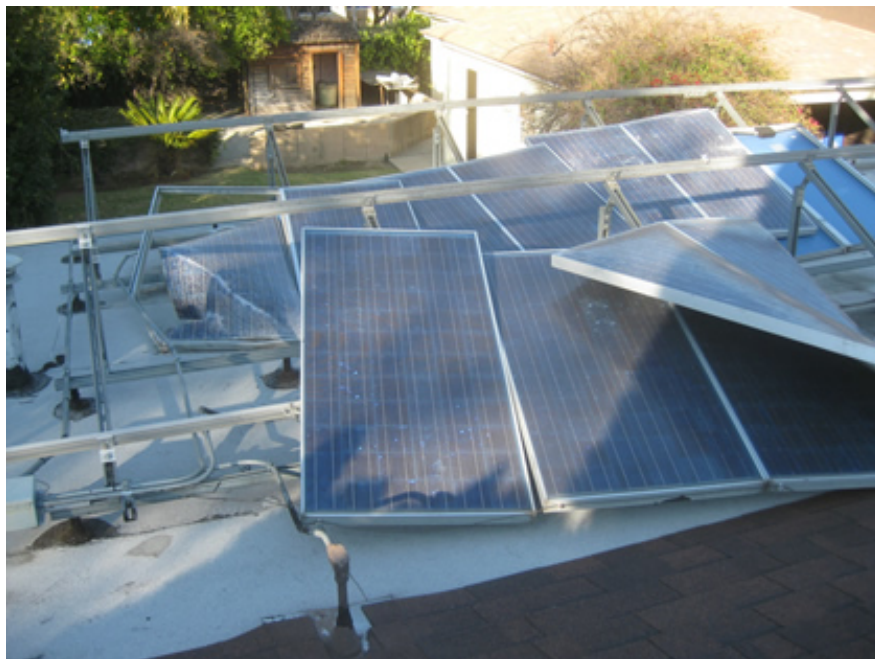
Figura 18. Los paneles solares arrancados y esparcidos por todos los anaqueles, tras el paso de una tormenta de viento en Pasadena. Recuperado de http://runonsun.com/runons5/blogs/blog1.php/solworks/safety/ros-2-windstorm-zero .
