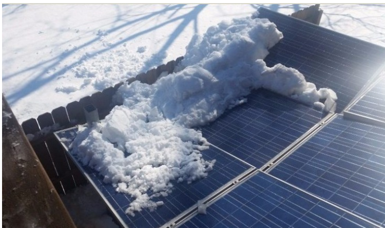
Figura 3. Estructura colapsada de un SFV debido al peso de la nieve. Por Strike Check, 2016. Retomado de http://www.strikecheck.com/2017/05/30/solar-energy-systems/ .
