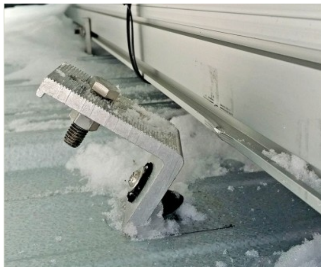
Figura 70. Las fuerzas de descenso resultantes de carga por nieve sobre el AFV fueron suficientes para sacar este sujetador tipo tornillo fuera de su viga o durmiente. En “Designing PV Systems for Environmental Extremes” , por David Brearley, 2015. Retomado de https://solarprofessional.com/articles/design-installation/designing-pv-systems-for-environmental-extremes.W8DgDvaZLIU . Copyright [2018] Home Power Inc.
