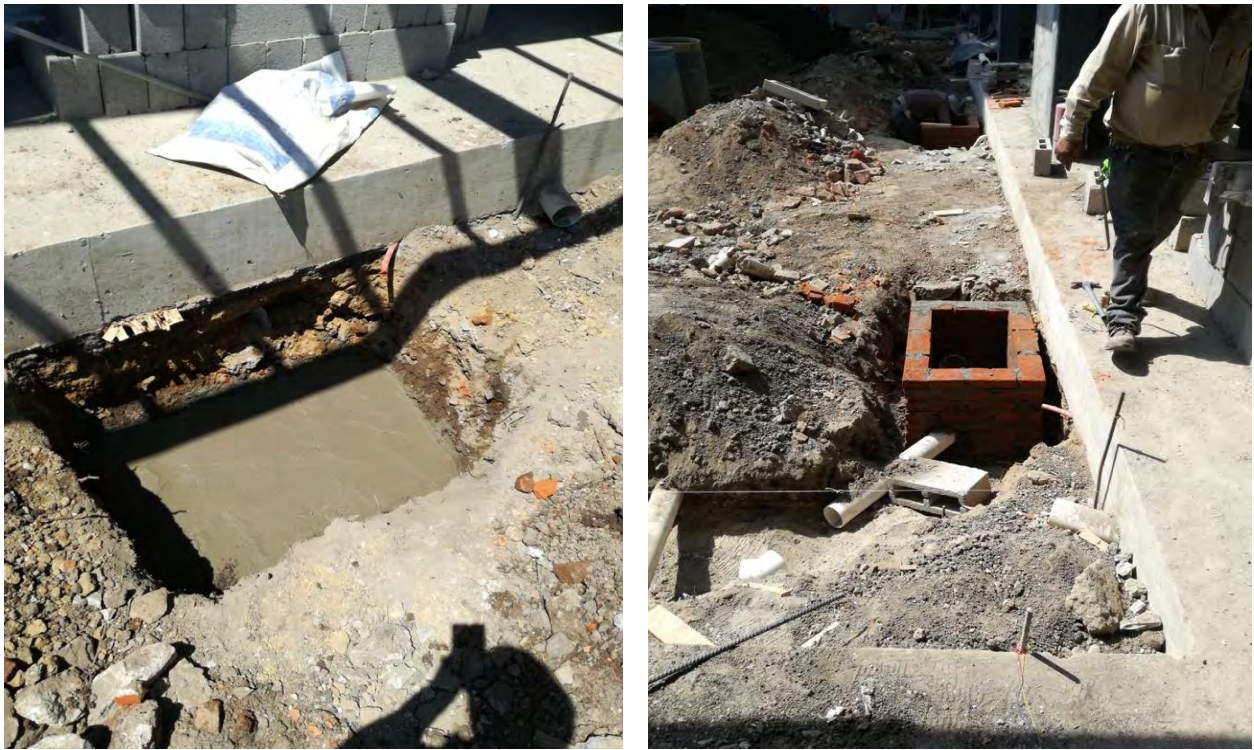
Imágenes 145 y 146: Colado de firme de concreto pobre y registro de tabique rojo
