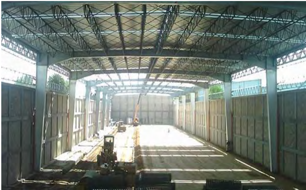
Imagen 12: Ejemplo de una nave industrial construida con elementos variados, se pueden apreciar los muros de block, la estructura de acero y las armaduras.
