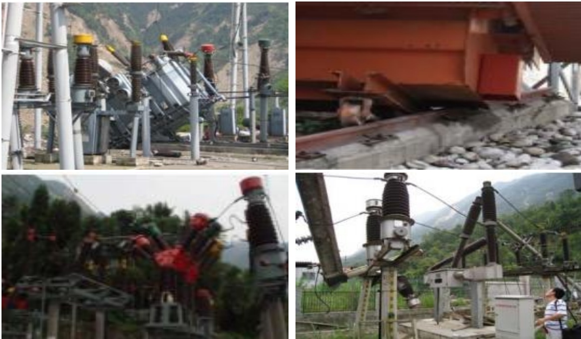
Figura 1.1. Imágenes de fallas y/o colapsos en equipos eléctricos o infraestructura eléctrica por terremoto (Pacific Earthquake Engineering Research Center, 2017).
