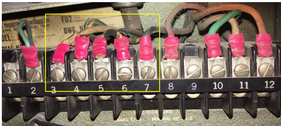
Imagen 11. Cables dañados en las terminales de entrada y salida.
