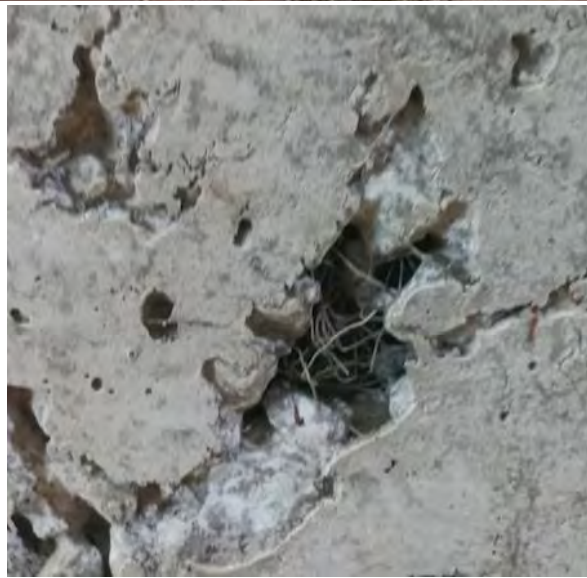
Erizos contenidos en vigas
