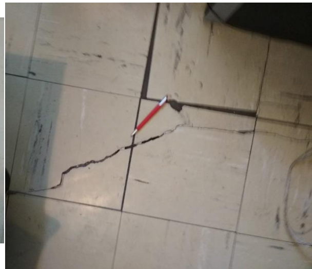
Fotografía 40. Fractura en el piso de la habitación secundaria.
