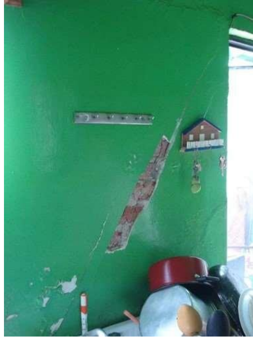
Fotografía 7. Fractura en la pared de la cocina.
