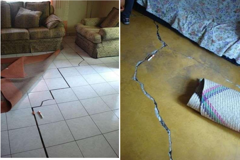
Fotografía 2. Fractura en piso de la sala (izquierda) y habitación continua (derecha).
