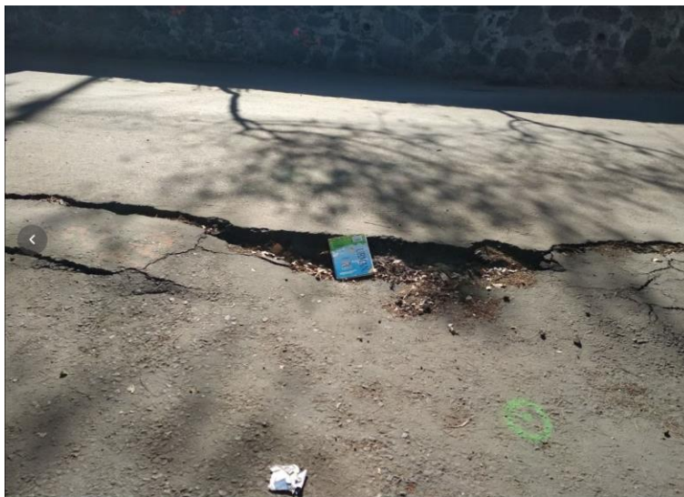
Fotografía 49. Escalonamiento de fractura en carretera México – Tulyehualco.
