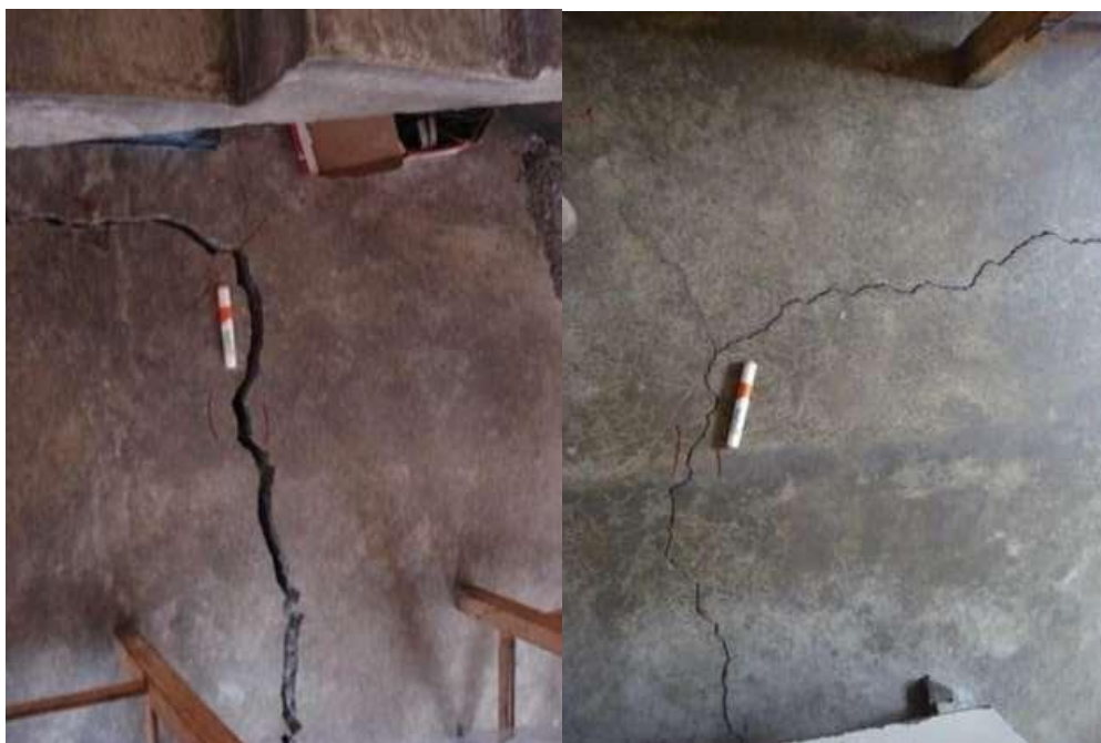
Fotografía 24. Fracturas en el piso de la sala.
