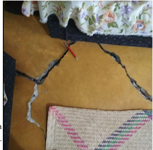
Fotografía 33. Fractura en el cuarto de descanso.
