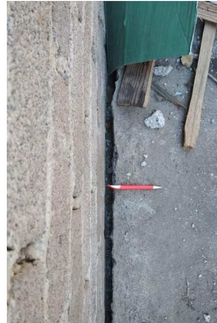
Fotografía 43. Separación entre muro de contención y losa del piso.
