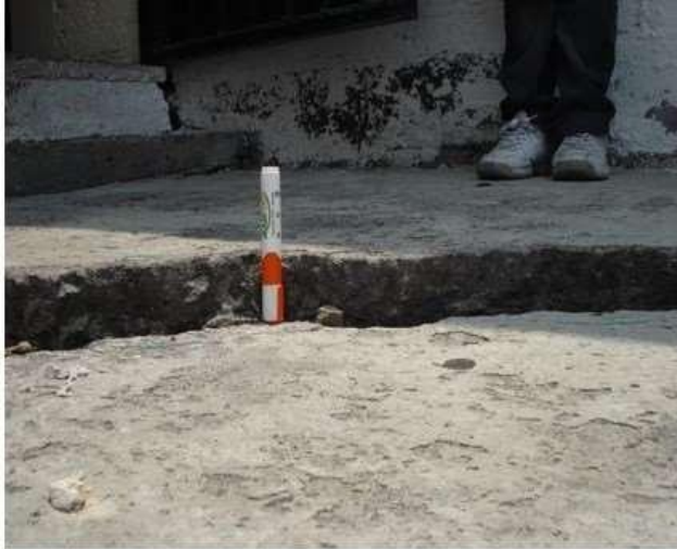
Fotografía 22. Escalón de falla en el patio
