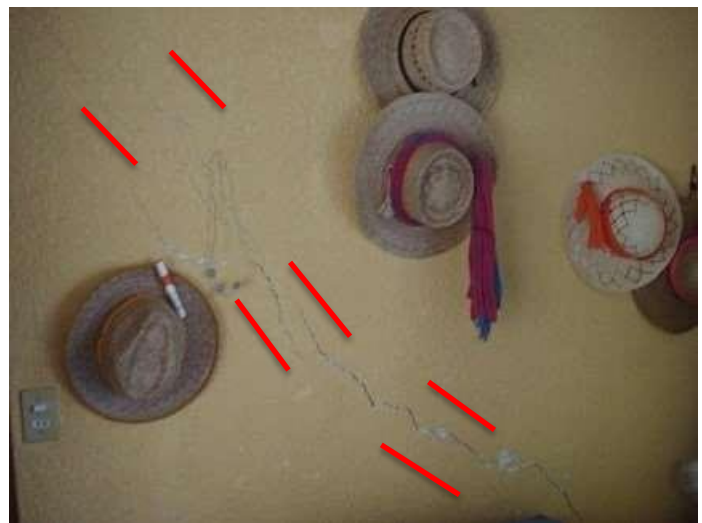
Fotografía 17. Fractura en la pared de la habitación
