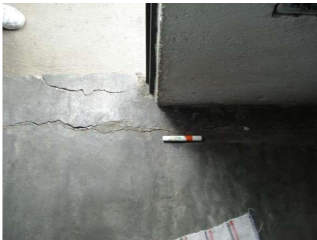
Fotografía 30. Fractura en el piso del comedor.
