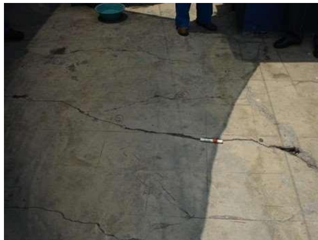
Fotografía 12. Fractura en el piso del patio.
