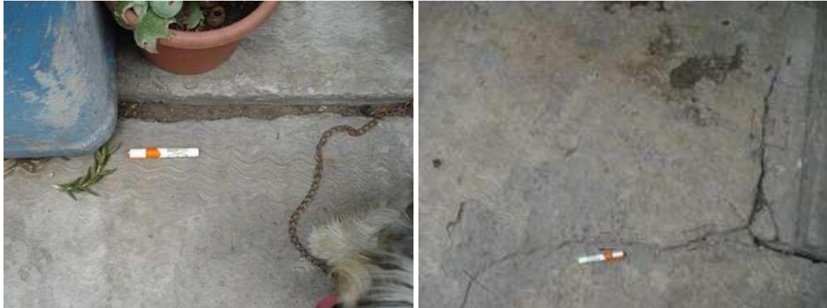
Fotografía 27. Fracturas en el patio
