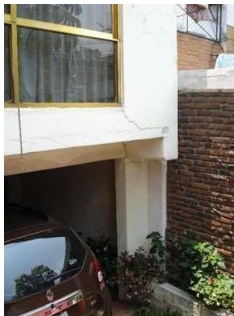
Fotografía 20. Fractura en la pared de la fachada
