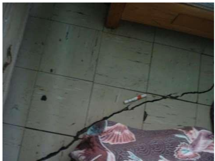
Fotografía 10. Fractura en el piso de cuarto.
