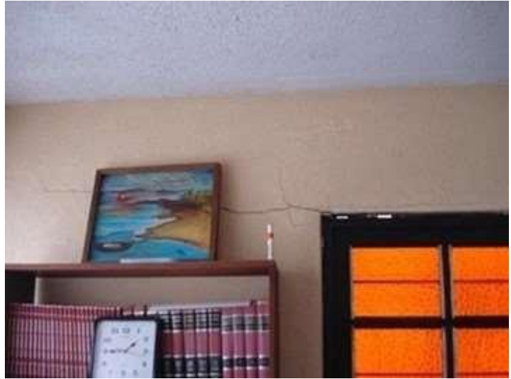
Fotografía 18. Fractura en la pared de la habitación
