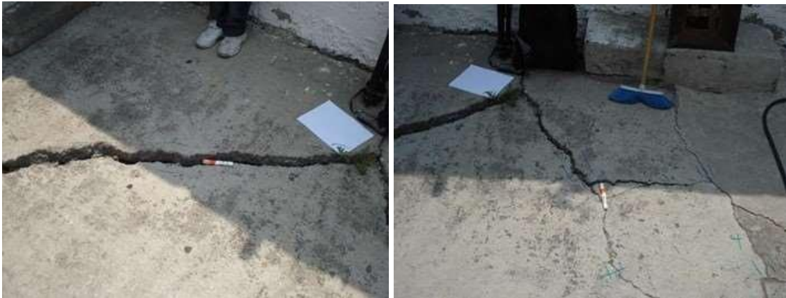
Fotografía 21. Fracturas en el piso del patio
