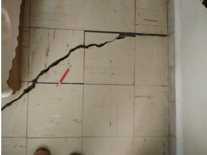
Fotografía 38. Fractura en el piso de la habitación principal.
