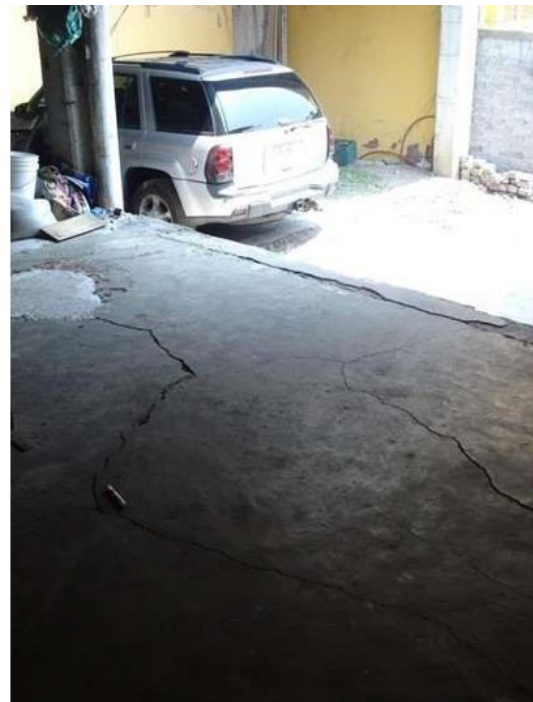
Fotografía 5. Fractura en el patio lateral de la casa
