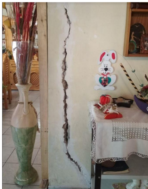
Fotografía 32. Fractura en la pared de la sala.
