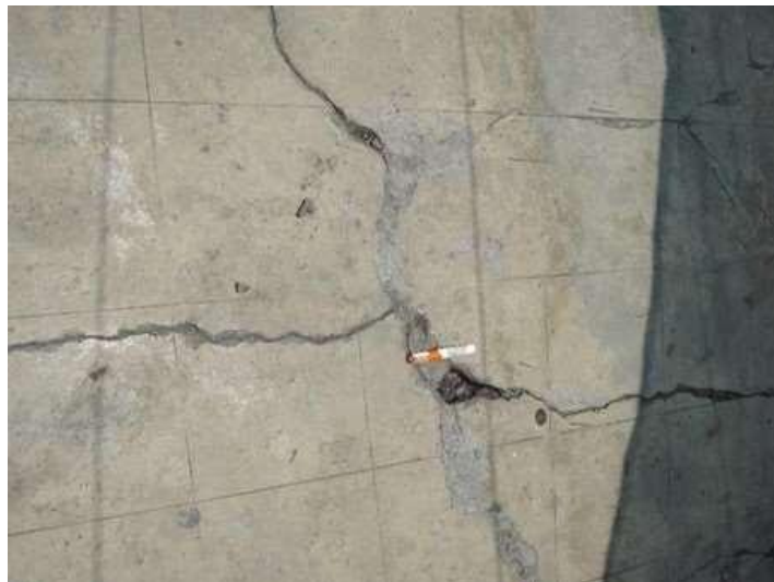
Fotografía 8. Fractura en el piso de la cocina.
