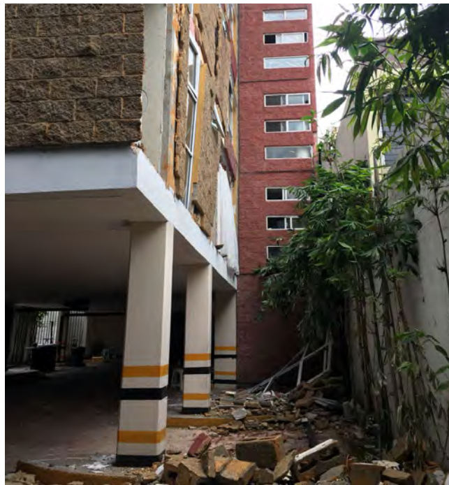
DAÑO FACHADA LATERAL FOTO: RODOLFO TORRES
