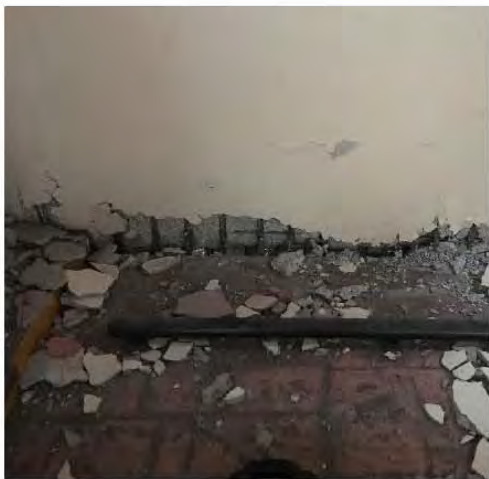
DAÑO EN MUERO DE CONCRETO FOTO: OSCAR DIAZ DE ITA
