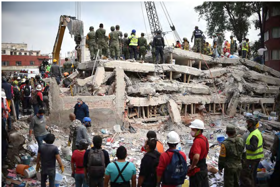
DERRUMBE EDIFICIO 19S 2017 FOTO: AFP. LATERCERA.COM
