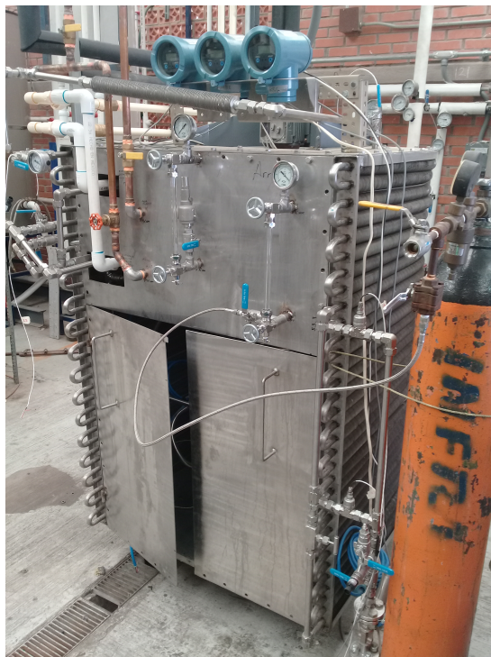
Figura 4.17: Presurizado del sistema usando nitrógeno.
