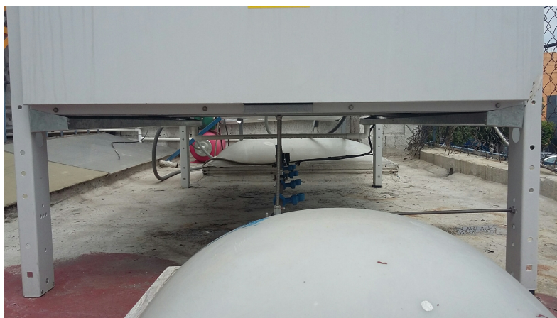
Figura C.13: Canaletas anti salpicadura bajo el serpentín rociado por aspersores
