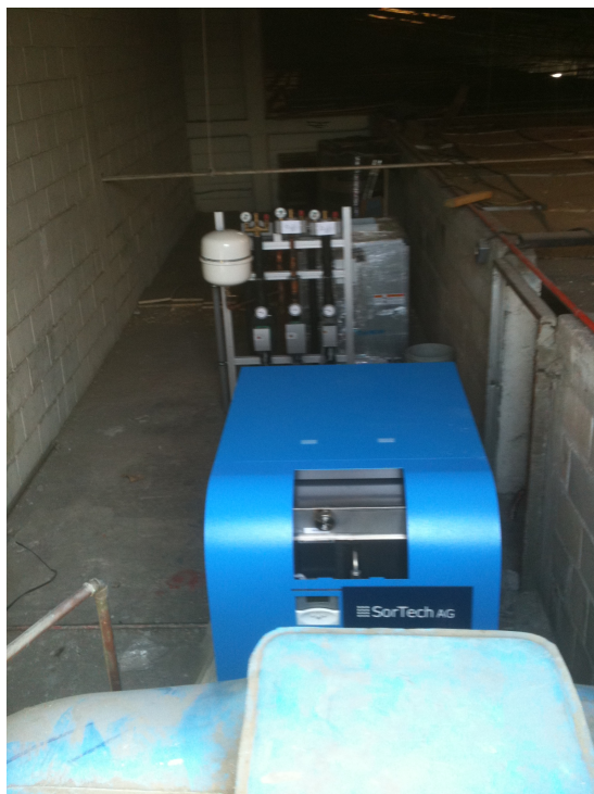
Figura C.5: Chiller, rack de bombeo y UMA
