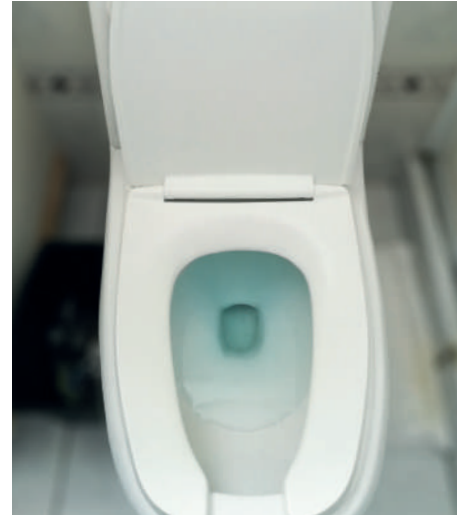
9. Si el agua se pigmenta, el escusado tiene una fuga que se debe reparar.
