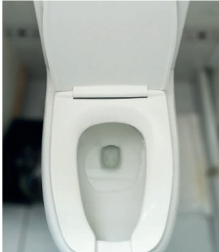
8. Observar el agua de la taza.
