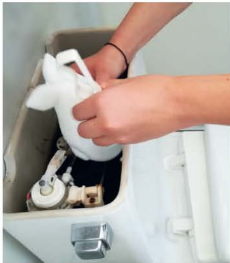
10. Sacar periódicamente a LBA para darle mantenimiento. Retirar el sujetador de la pared del tanque.
