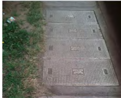
Figura 64 Acometida de Telmex, Bordo de Xochiaca. La línea telefónica funciona de manera adecuada en el entorno
