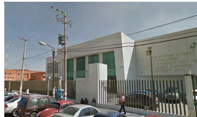
Figura 67 Transformador más cercano (a 200 apróx.). Se encuentra frente al centro de reinserción social. Existen varios edificios cercanos al predio seleccionado y todos cuentan con energía eléctrica
