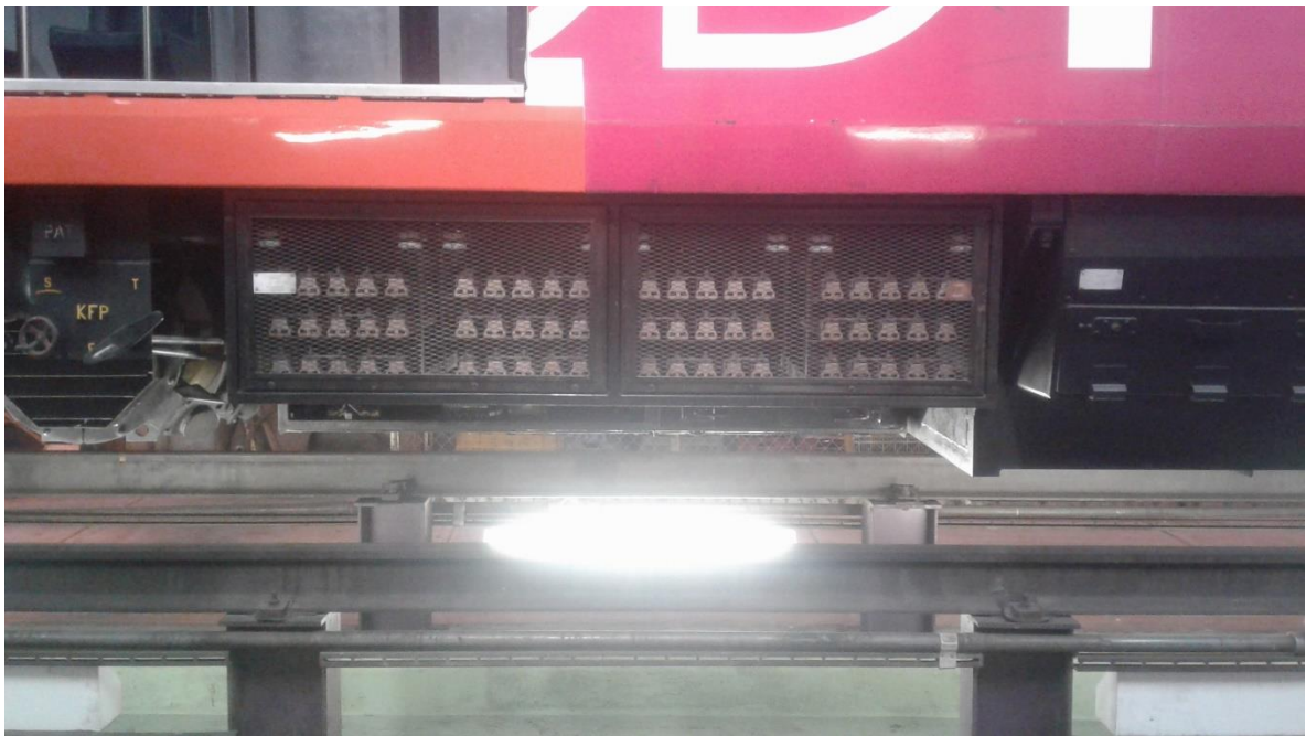
Fig. 3.8: Banco de resistencias, en vista lateral y bajo bastidor.
