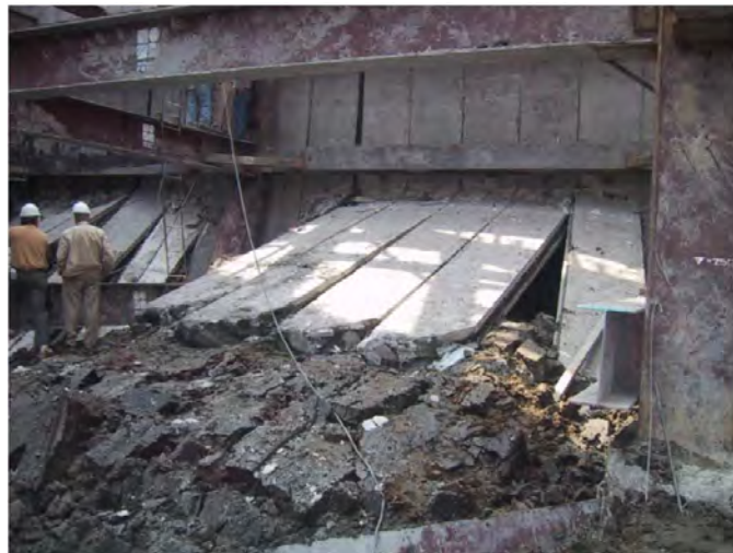
Figura 5.1. Tabletas de concreto de 1.0m de ancho y 0.3m de espesor, desplantadas a 13.5m de profundidad; al centro se observan los pies de las tabletas prefabricadas de concreto reforzado; se aprecian también las columnas y travesaños de los sótanos que constituyen el sistema de retención (Cuevas, 2012).
