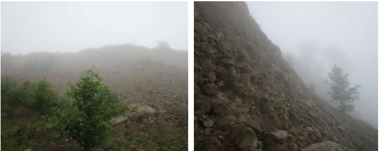
Figura 46. Superficie expuesta del escarpe y la vegetación preexistente de la masa trasladada (izquierda) y vista de perfil del límite entre el escarpe y la masa trasladada (derecha). La superficie de falla alcanza ángulos de 57^\circ al inicio y de 34^\circ al final del escarpe
