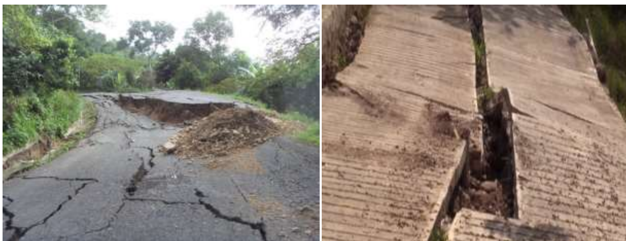
Figura 92. Ejemplos del tipo de daños mostrados en la carretera entre las localidades del municipio de Juchique de Ferrer y Plan de las Hayas antes de llegar a la colonia Libres, por precipitaciones del 18 de septiembre de 2010 (izquierda) y el tramo de carretera Colipa-Dehesa por un deslizamiento ocurrido el 18 de septiembre de 2017 (derecha)
