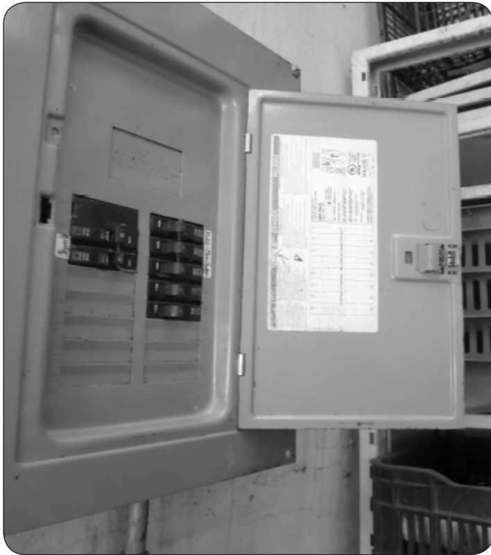
Figura 2.14 Tablero de pastillas interruptoras termomagnéticas en la planta generadora de biogás en Ciudad Universitaria
