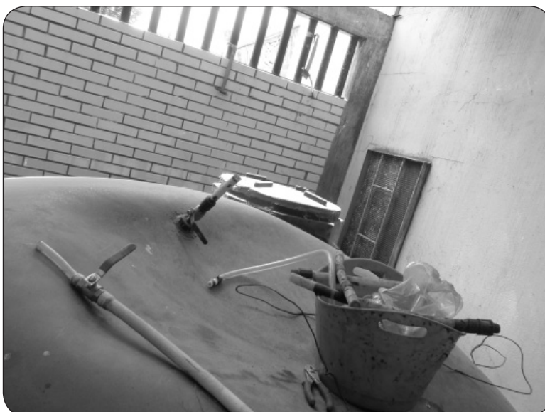
Figura 2.36 Vista de una parte de la planta productora de biogás donde se pretende mostrar la tubería, de color amarillo, por donde circula el biogás
