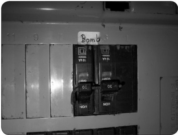
Figura 2.25 Pastillas interruptoras termomagnéticas para accionar la bomba
