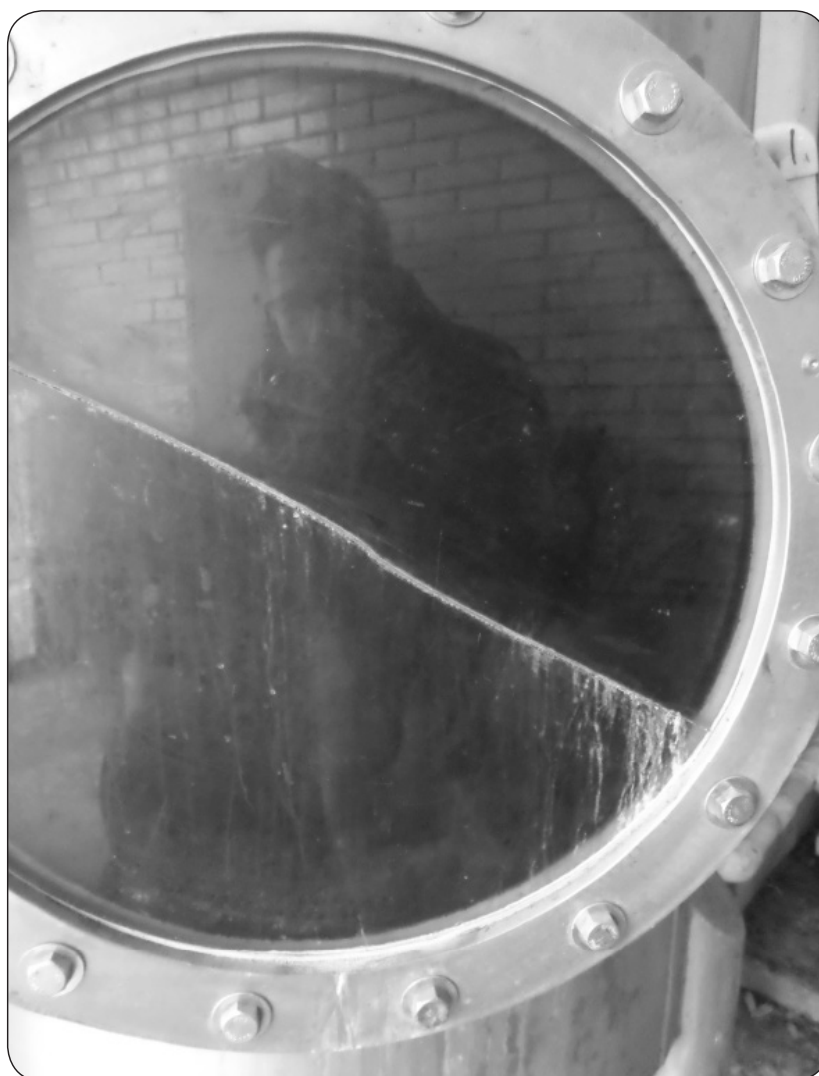
Figura 2.17 Ventanilla del reactor anaerobio R-I donde se aprecia el mezclado de la biomasa
