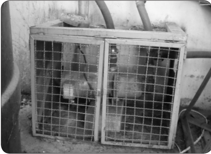
Figura 2.9 Bomba en jaula de protección
