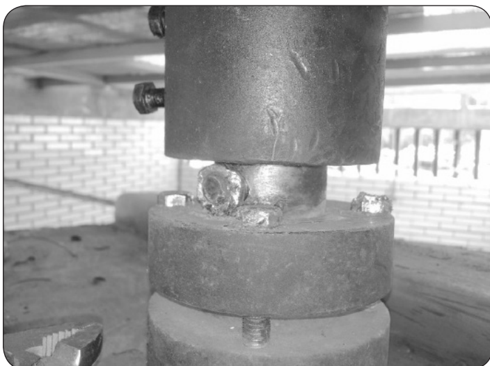
Figura 2.34 Engranés y tuercas del motor del reactor anaerobio R-I sin mantenimiento
