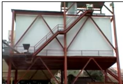
Figura IV.7 Fábrica de escamas de hielo, para sustitución del agua de la mezcla del concreto. Rendimiento de 66 ton al día.
