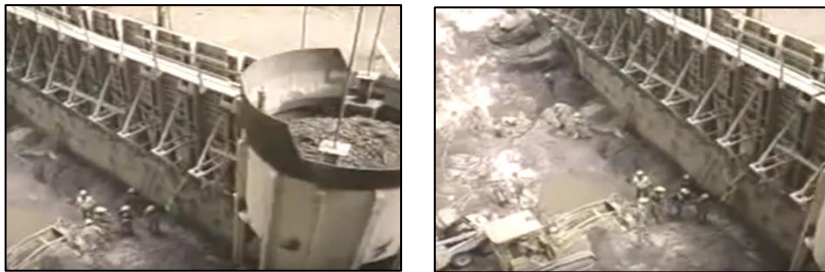
Figura IV.14 Fotos de la movilización y colocación del concreto en el P.H. Zimapán.
