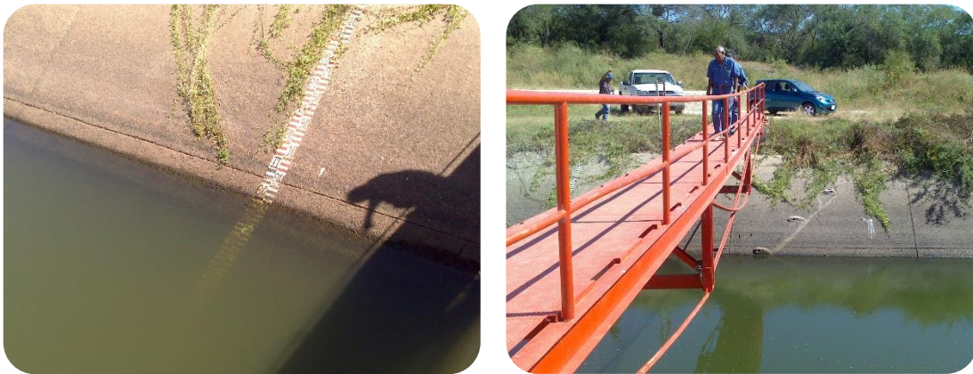
figura 1. Sección de control en el distrito de riego 076.
