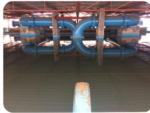
b) Tubería de llegada
