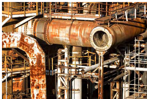
Figura 1. 2 Tuberías sometidas a corrosión
