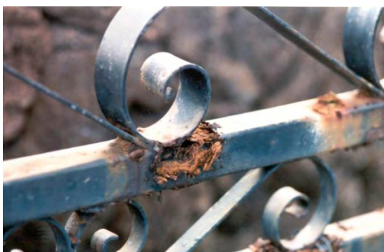
Figura 1. 6 Barandal expuesto a corrosión por crevice en la cavidad entre ambas piezas
