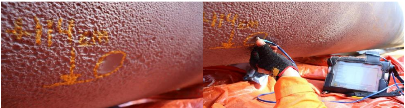
Fotografías 12,13. Detalle de una zona que presenta desbaste mecánico Medición del espesor remanente en la zona con desbaste
