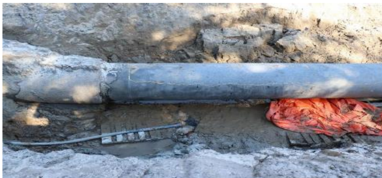
Fotografía 9. Vista general del carrete inspeccionado, se observa el área con pérdida de metal delimitada, dirección del flujo izquierda derecha.
