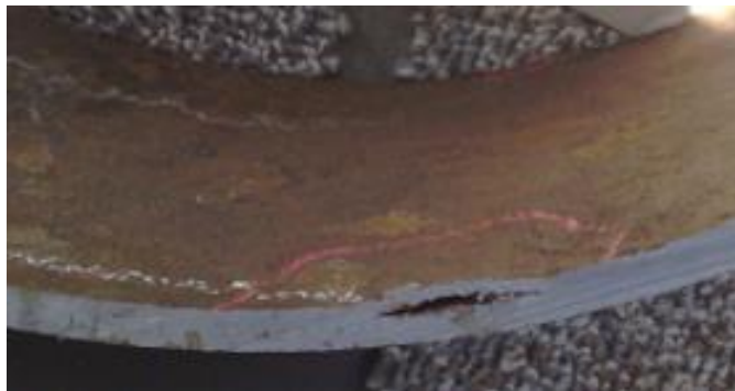
Figura 26. Ejemplo de laminación en tubería
