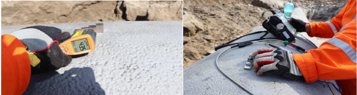
Fotografías 10,11. Preparación block de calibración previo a ajuste del equipo de UT y ajuste en sitio de equipo de ultrasonido portátil, haz recto
