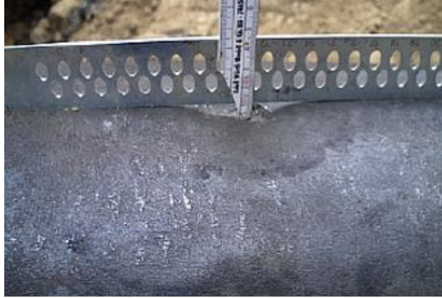
Figura 27. Ejemplo de abolladura en tubería
