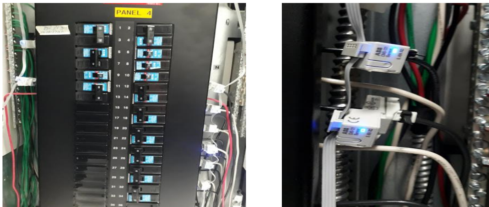
Figura 4.5 a) Tablero eléctrico de servidores, con varios sensores BCM, b) Sensores BCM monitoreando cargas
