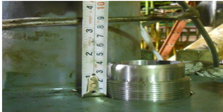
Figura 3.2: Penetrador instalado en el cabezal y mostrando que sobresale insuficiente cuerda realizar conexión.
