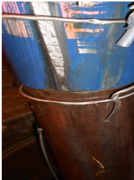
Figura 3.8: Rotura de la línea de control de la válvula de tormenta.
