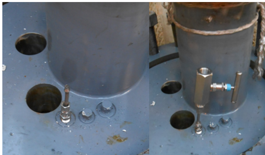
Figura 4.10: Tornillo de terminación instalado de manera “pasante”.
