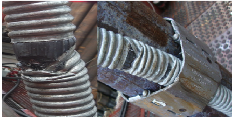
Figura 3.4: Cable de potencia dañado.
