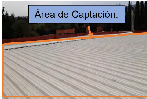
Figura 11.- Techo de la AMC utilizado para la captación de agua de lluvia.
