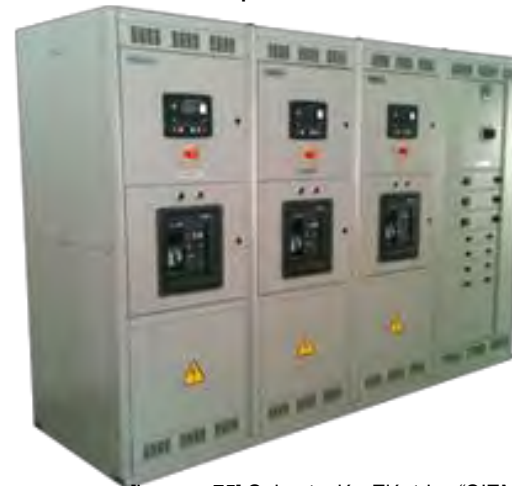
[Imagen 75] Subestación Eléctrica "SIEMENS"
