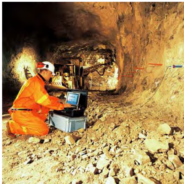
Figura 2.5. Disposición de los sensores registradores en la pared del túnel de la técnica TSP. Tomado de http://www.ambergtechnologies.ch .
