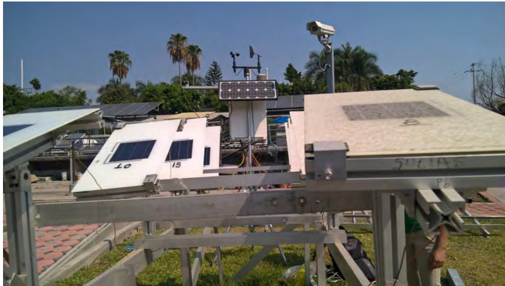
Fig. 4.48. Ensuciamiento máximo en las celdas.
