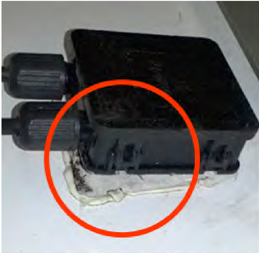
Fig. 3.3. Caja de conexión con falla.
