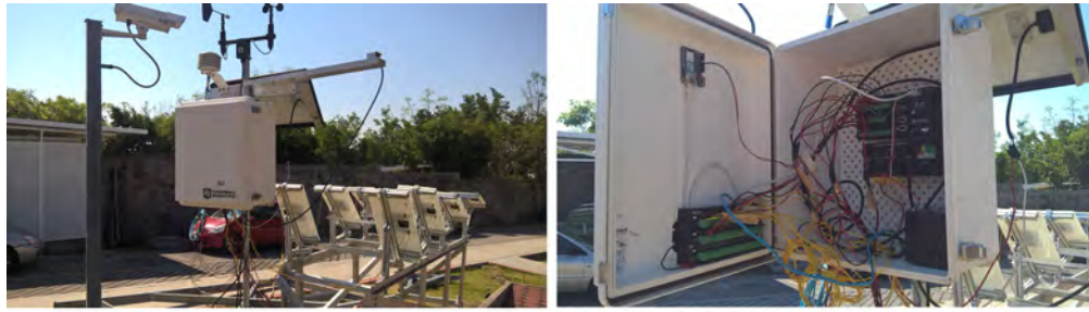
Fig. 3.33. Estación para mediciones ambientales, se muestran las conexiones.
