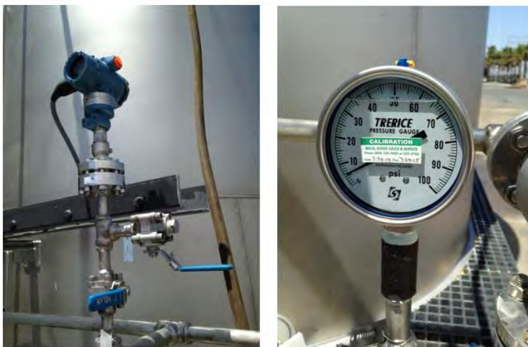
Figura 4.5 Indicadores de presión en sistema de inyección de químicos.
