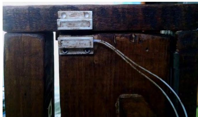
Figura 4.24 Interruptor magnético colocado en la parte superior de la puerta. (Fuente: Elaboración propia)
