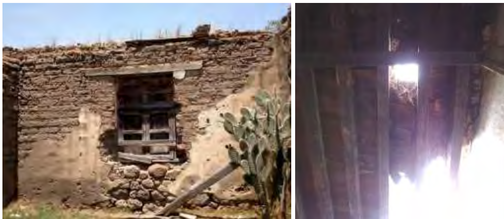
Figura 65 Muro con pérdida de aplanado e invasión de vegetación y cubierta con colapso en las Calpanerías, 2016.
