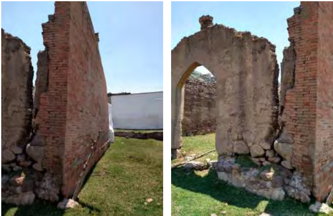
Figura 93 Daños del Almacén de Carbón.
