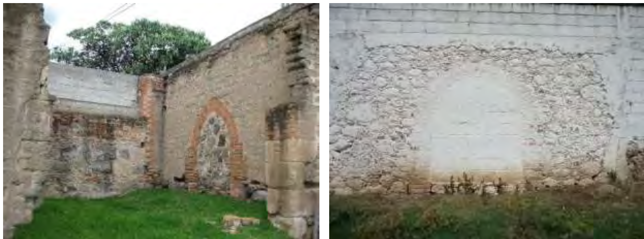
Figura 67 Vanos tapiados en puertas Calpanerías y tapia perimetral, 2016.
