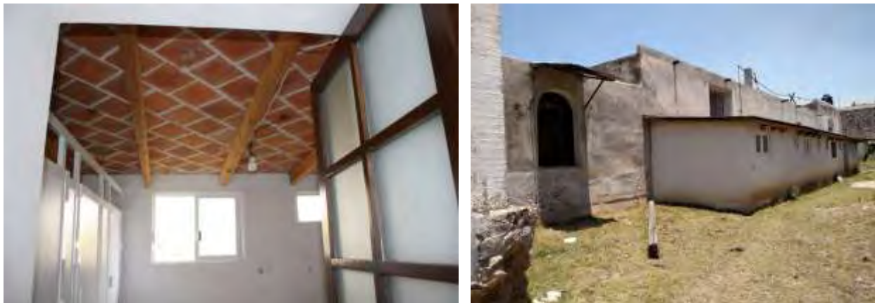
Figura 69. Vista interior y exterior de los núcleos de sanitarios en la Casa del Hacendado, 2016.
