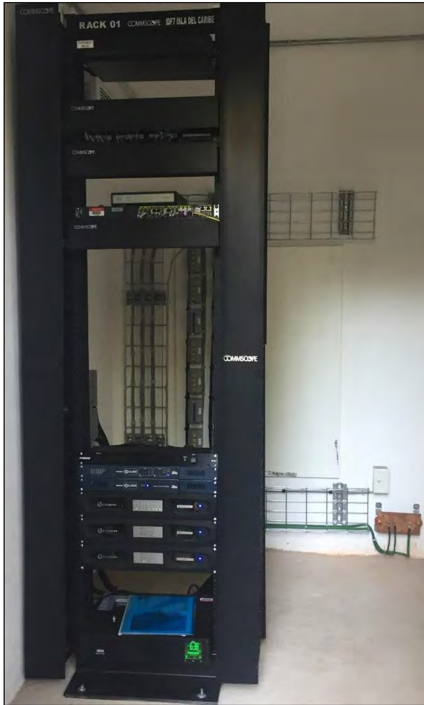
Figura 7.11 Imagen frontal de rack del IDF 7
