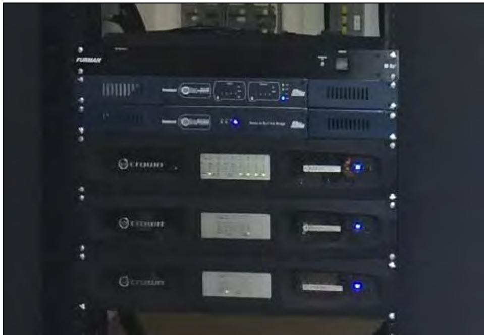
Figura 7.2 Equipo de audio montado en rack en un IDF
