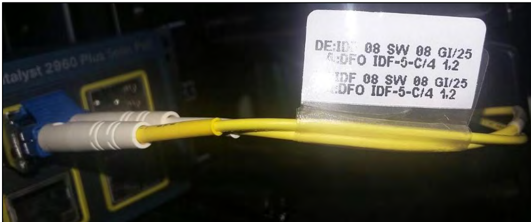
Figura 7.6 Etiquetado de jumper de fibra óptica
