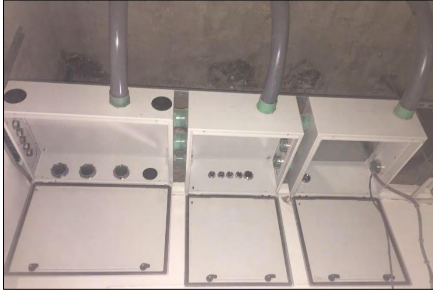
Figura 8.4 Registros metálicos instalados
