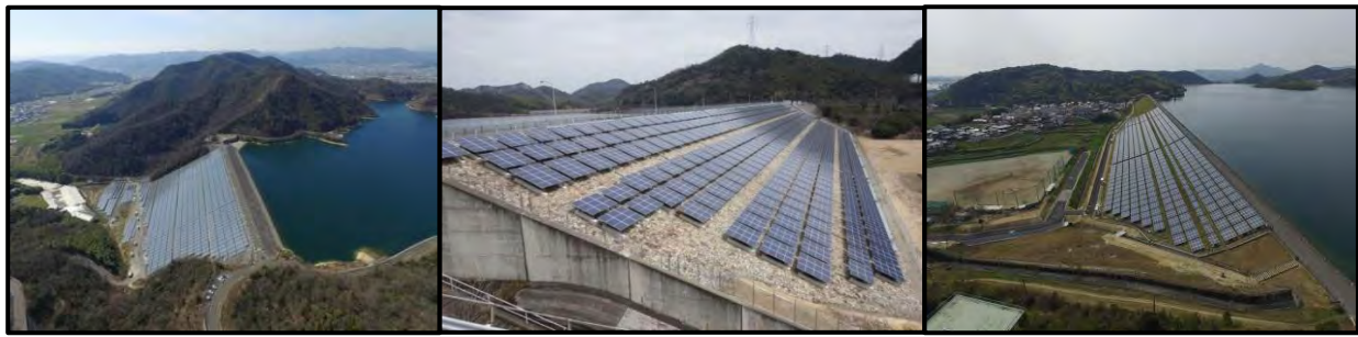
Figura 2.2- Presa Kotani, Gongen y Heiso con sistemas fotovoltaicos en cortinas.
