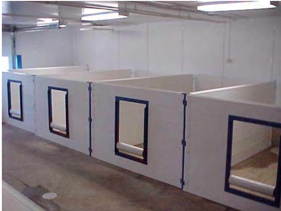
Figura 2.29. Cajas nidas instaladas para la llegada de las cerdas próximas a parir. Tomado de: Li et al. , 2010. Disponible en: https://wcroc.cfans.umn.edu/research-programs/swine/housing
