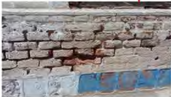
Desgaste de juntas y erosión de los ladrillos, presenta falta de elementos en la composición.
