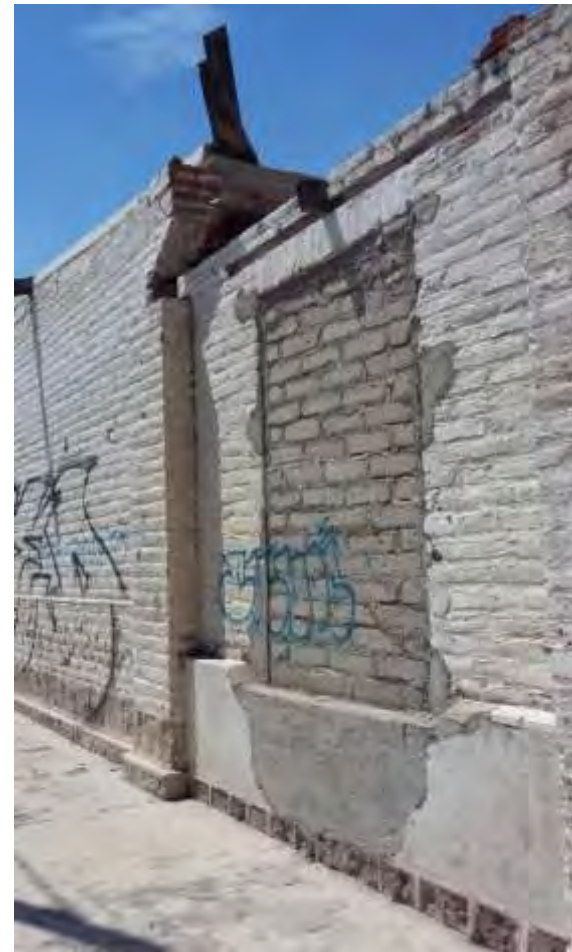
Foto 19. Ventana tapiada para evitar el acceso a personas extrañas que pudieran acelerar el deterioro de la construcción.
