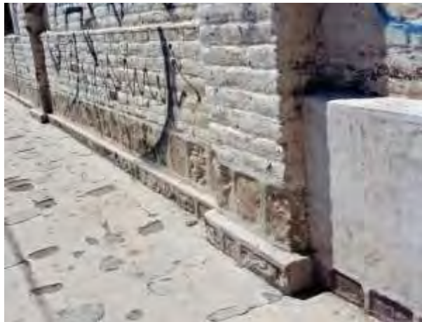
Foto 17. Cimentación expuesta, debido a cambio de nivel de calle al paso de los años.
