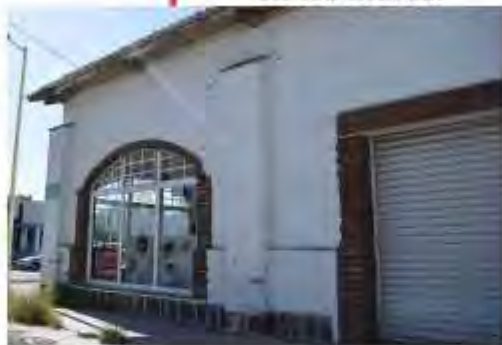
Falta de mantenimiento en los muros.
