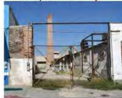
Falta de mantenimiento, abandono, pérdida de aplanados
