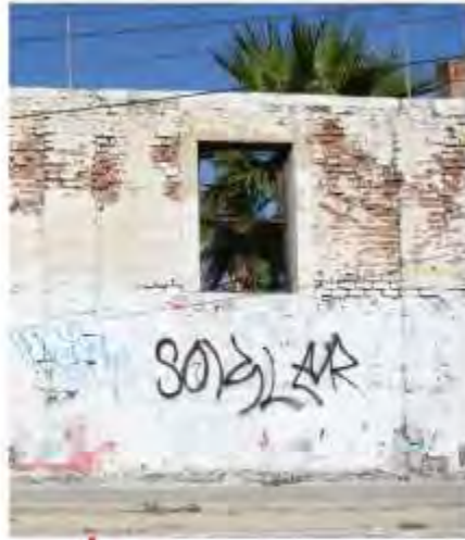
Faltante de ventana, aplanado y juntas.
