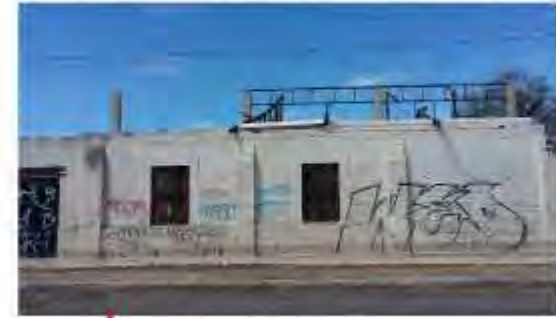
Perdida de elementos en muro, pierde soporte el sistema de armaduras de madera.
