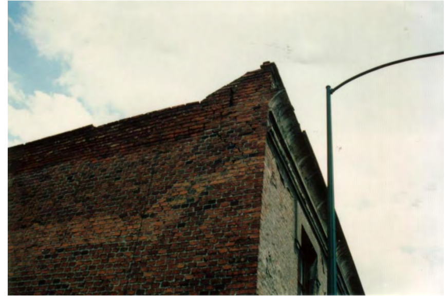
CORNIZA EROSIONADA CUARTEADURA EN PRETIL APLANADOS DESPRENDIDOS
