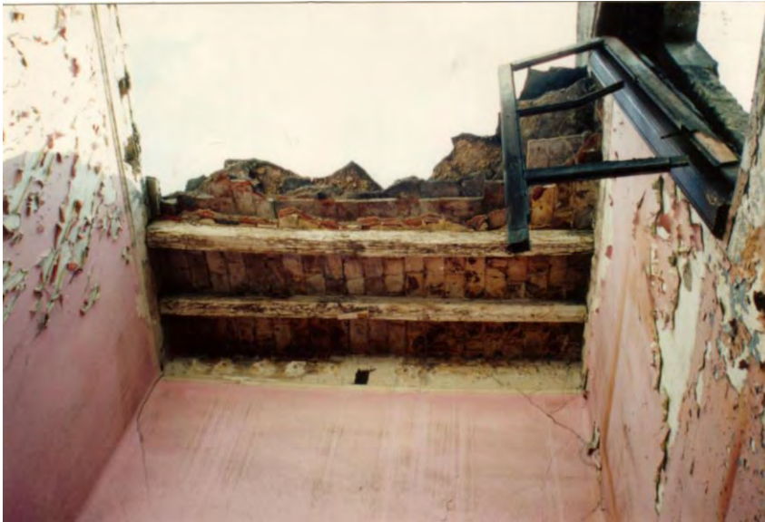
TECHUMBRE DE VIGUERIA Y TERRADO DERRUIDO VENTANA DETERIORADA
