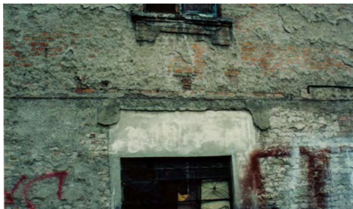
VANO MODIFICADO, APLANADOS DESPRENDIDOS
