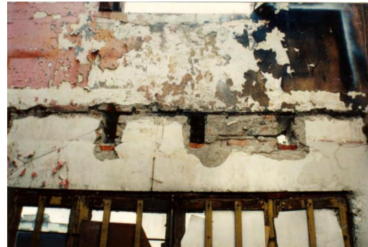
FALTANTE DE VIGUERIA, RASTROS DE INCENDIO PORTON DETERIORADO
