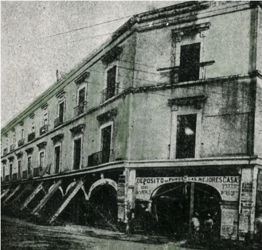
Imagen 2.4 DAÑOS EN PORTAL DE LOS AGUSTINOS
