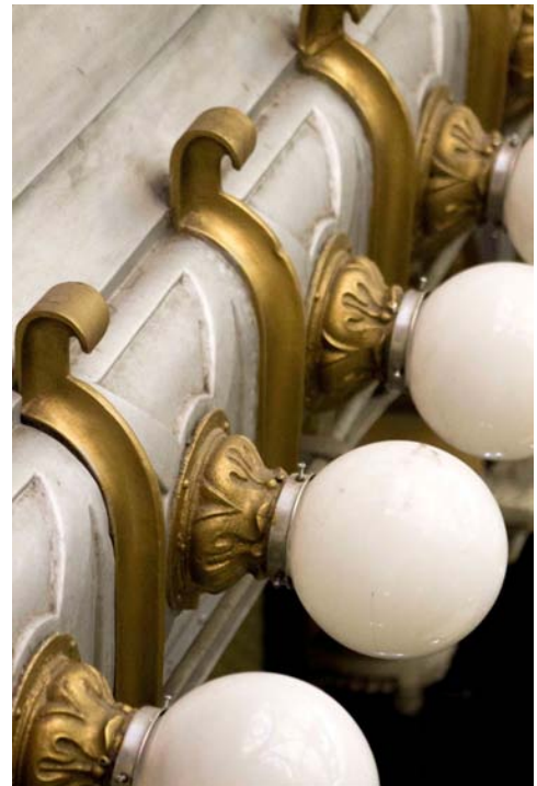
Imagen 3.29 DETALLE INSTALACION ELECTRICA DEL GRAN HOTEL DE LA CIUDAD DE MÉXICO (Antes El Centro Mercantil)
