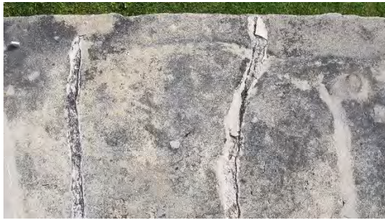
Figura 35. Detalle de algunas de las grietas presentes en la terraza del 2º nivel del Edificio 16 o Templo de las Pinturas, Tulum. R. Magdaleno, 2012.
