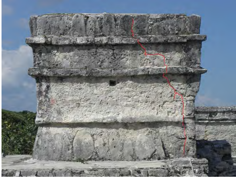
Figura 21. Templo superior, fachada sur, Edificio 16, Tulum. En la imagen se resalta la grieta que va del nivel de la azotea a la base del Templo Superior. R. Magdaleno, 2012.
