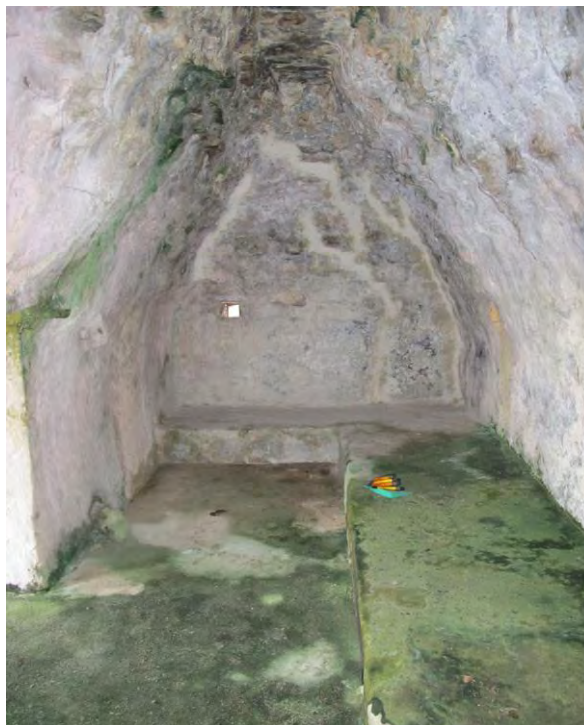
Figura 74. Cámara posterior del Templo del Edificio 1, obsérvese el piso y la banqueta saturados de humedad y microorganismos después de realizar una limpieza en seco de la superficie, R. Magdaleno, 2015.
