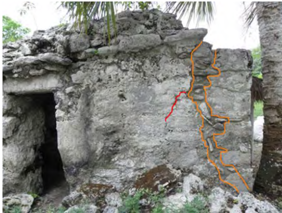
Figura 122. Detalle sección norte, fachada este, Estructura 7H-3; en naranja la sección intervenida, en rojo las nuevas grietas. Muyil. R. Magdaleno, 2011.
