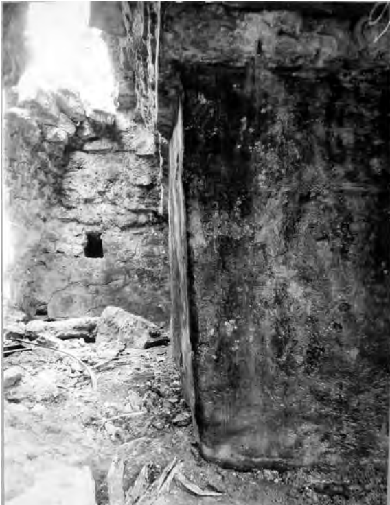
Figura 33. Esquina noroeste del Santuario Interior y crujía norte, 1er nivel Edificio 16. En la imagen se destaca la pérdida de la bóveda en la crujía. Archivo Peabody Museum, Universidad de Harvard, 1924
