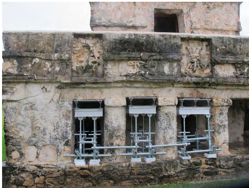
Figura 55. Detalle de la mitad norte de la fachada principal del Edificio 16 de Tulum con la colocación de los tres sistemas de apuntalamiento bajo los dinteles fracturados. R. Magdaleno, 2013.
