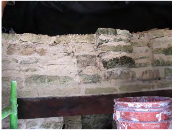
Figura 131. Detalle del proceso de edificación del friso-caja, previo a empezar los trabajos de relleno al interior. Imagen PMQR.
