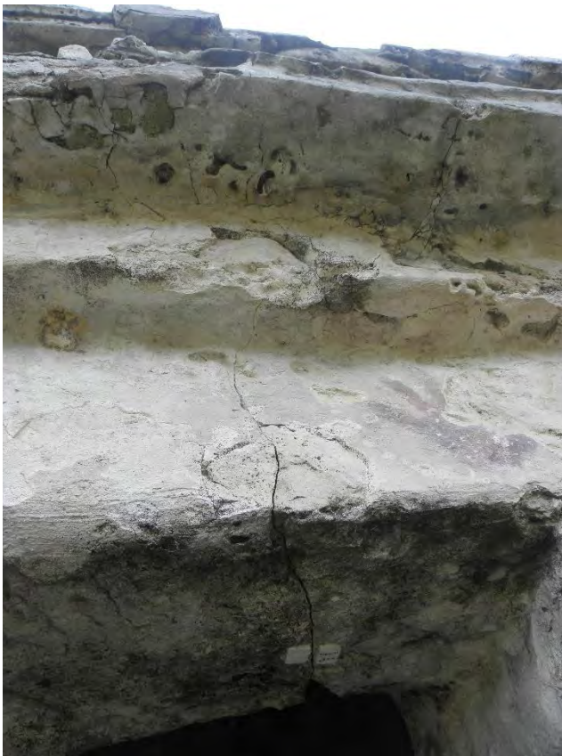
Figura 20. Detalle de la fractura del dintel 2 (ver planta arquitectónica en la figura 12), Edificio 16, Tulum. R. Magdaleno, 2011.
