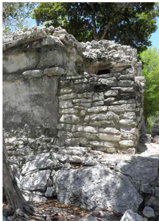
Figura 117. Detalle de la junta fría entre la primera y segunda etapa constructiva en la sección norte de la fachada posterior. Obsérvese la pérdida de la bóveda. R. Magdaleno, 2011.
