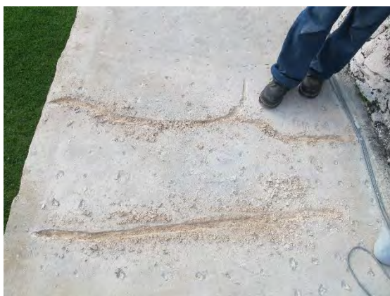
Figura 37. Apertura de las grietas, terraza Edificio 16. R. Magdaleno, 2012.
