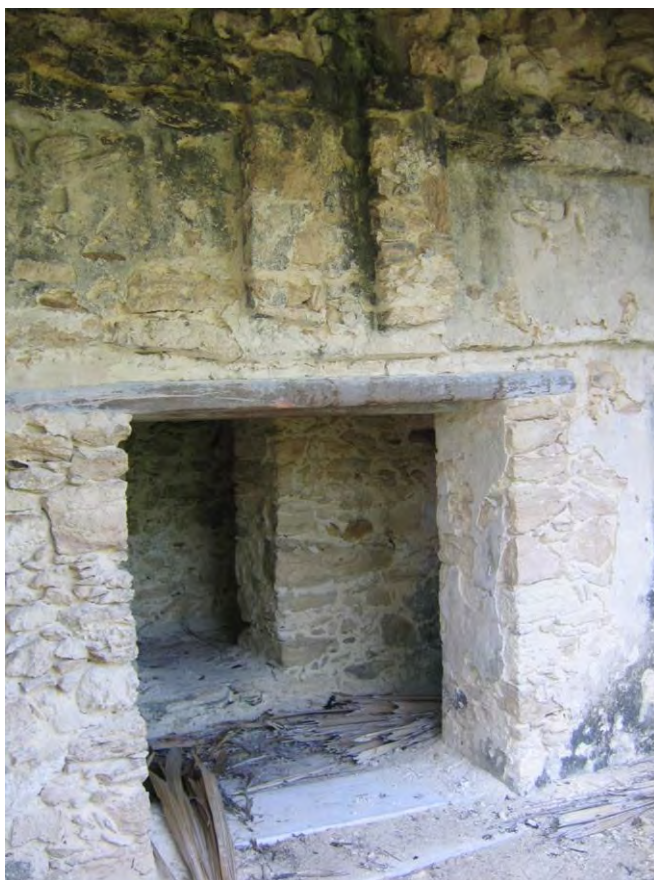
Figura 128. Fachada oeste del Templo de la Subestructura de El Castillo, vista desde el sureste. Fotografía previa a los trabajos de intervención en 2012, en ella se puede observar el estado de conservación de los componentes arquitectónicos y sus relieves de “Las Garzas”. Imagen PMQR.
