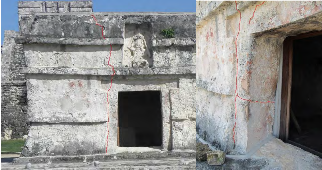
Figura 22. Fachada frontal o poniente, Templo Superior, Edificio 16, Tulum. En la imagen de la izquierda se resalta la grieta que se origina en el remate de azotea, pasando por la moldura superior, friso, moldura media y corre su trayectoria entre la jamba hasta llegar a la plataforma. En la imagen de la derecha se tiene una vista desde el suroeste con el detalle de la jamba y el vano de acceso, donde se destaca la ramificación de la grieta fracturando la jamba. R. Magdaleno, 2012.
