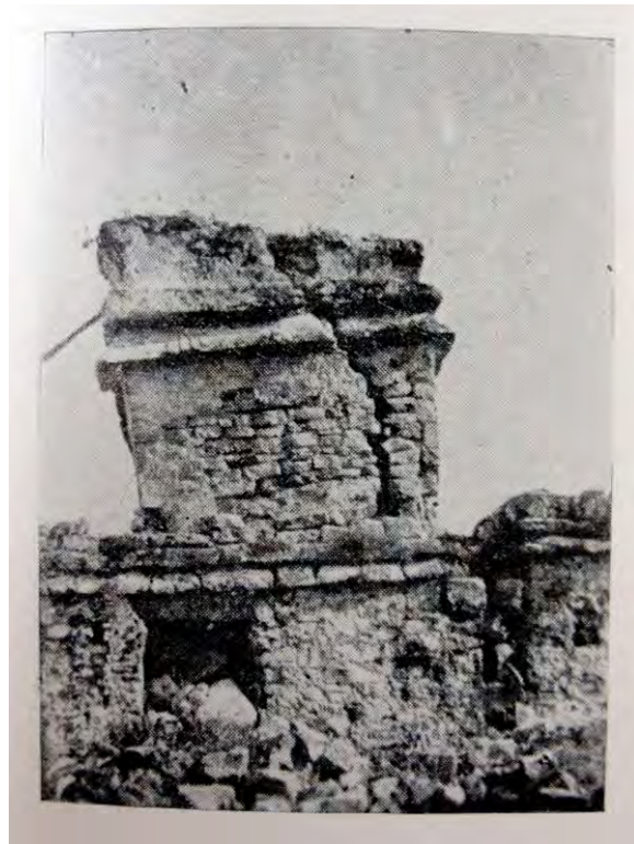
Figura 84. Edificio 5, apuntalado, fracturado y saqueado. M. A. Fernández, 1945.
