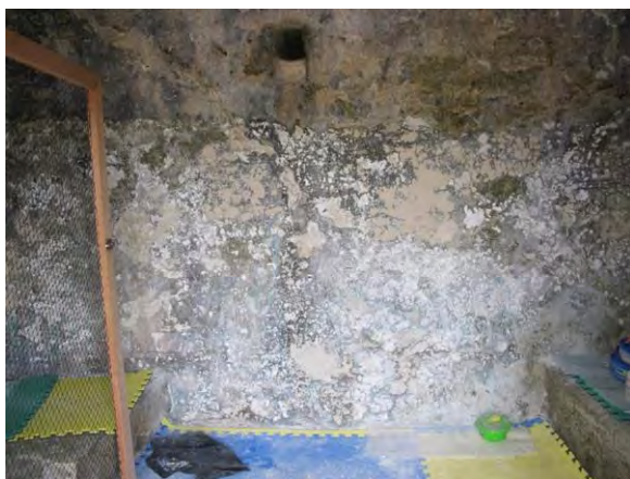
Figura 85. Muro posterior en la cámara del Edificio 5, visto desde el acceso al poniente. En la imagen se destaca la pérdida de la superficie pictórica y zonas con microorganismos. PMQR, 2012.
