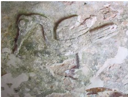
Figura 129. Detalle de la Garza sur previo a los trabajos de restauración, nótese las áreas de pérdida de material y en general el estado de conservación. Imagen PMQR.
