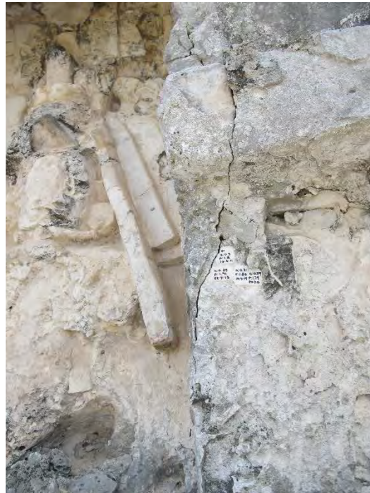
Figura 31. Registro fotográfico de una de las grietas localizada en el costado sur del nicho en el friso del Templo Superior, Edificio 16, Tulum. R. Magdaleno, 2015.
