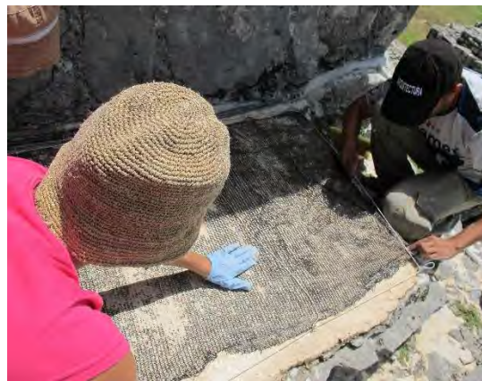
Figura 40. Colocación de la malla plástica encima del primer entortado y previo al entortado final, Edificio 16, Tulum. PMQR, 2012.
