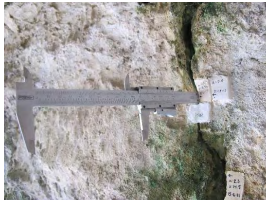
Figura 29. Detalle de medición de las grietas con calibrador Vernier. R. Magdaleno, 2011.
