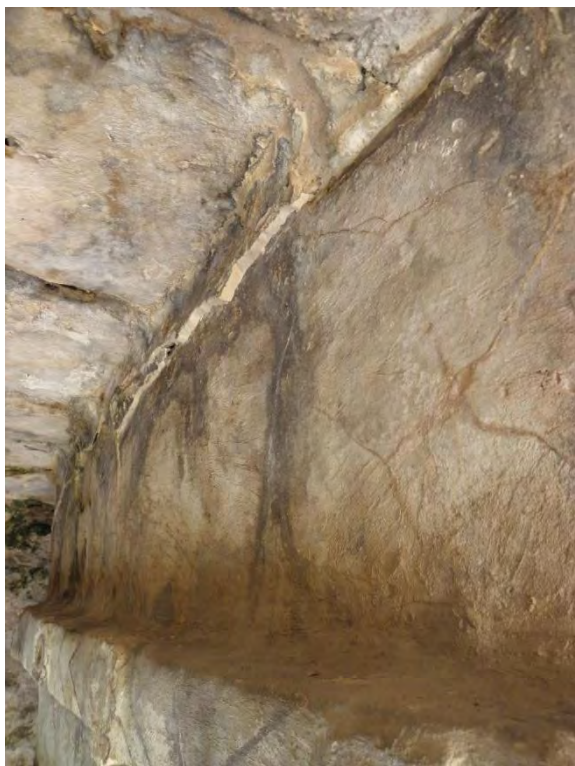
Figura 19. Detalle del remate superior en la fachada del Santuario Interior y las tapas de bóveda, obsérvese la separación del aplanado entre ambos elementos. R. Magdaleno, 2016.
