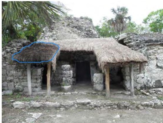
Figura 121. Fachada principal con el techo de palma como protección que sin la pendiente adecuada la palma se está pudriendo –sección izquierda de la imagen en contorno azul- y genera filtraciones al interior, Estructura 7H-3, Muyil. R. Magdaleno, 2011.
