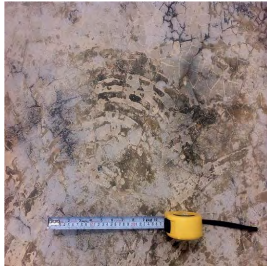
Figura 89. Detalle craqueladuras y fisuras en la superficie de la azotea del Edificio 5. F. Godos, 2014.
