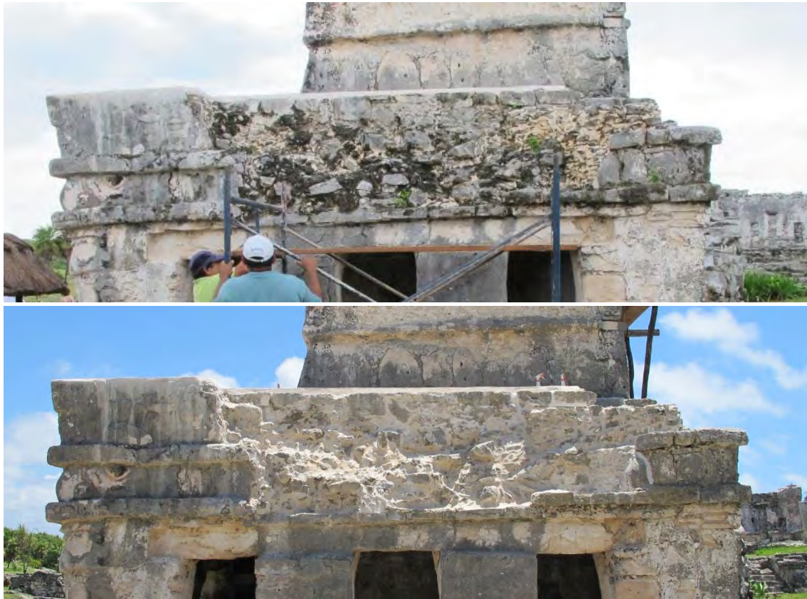
Figura 45. Detalle de la fachada sur a la altura del friso en el primer nivel del Edificio 16. En la imagen superior el estado del núcleo expuesto de la bóveda previo a los trabajos de intervención. En la imagen inferior el mismo núcleo después de la limpieza y reposición de juntas con morteros de cal. R. Magdaleno, 2014.
