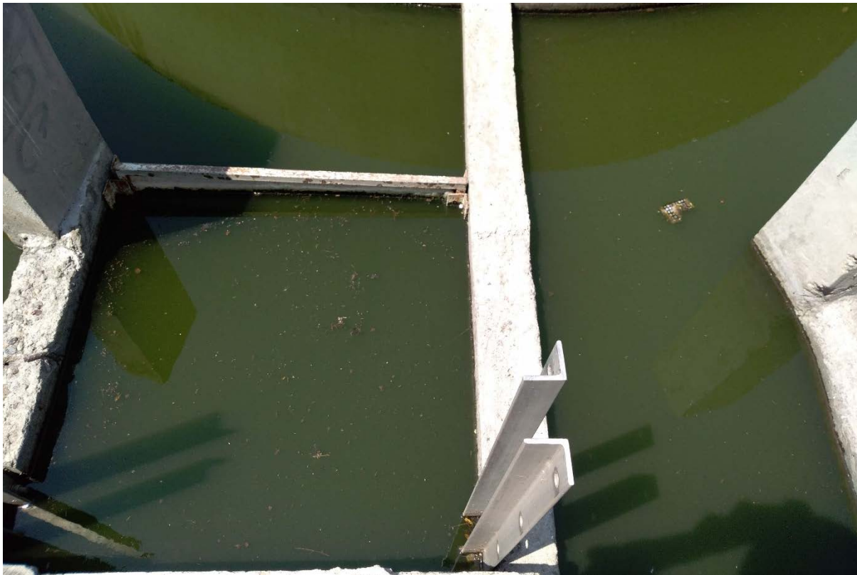
Figura 5-3. Canales de conducción en el sistema.
