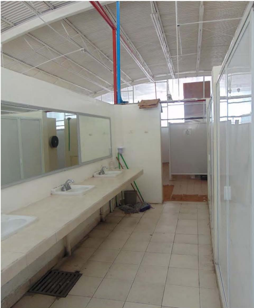
Fig. 100 Área de lavabos y sanitarios, BIM 29 Cuemanco, Xochimilco, CDMX (147)
