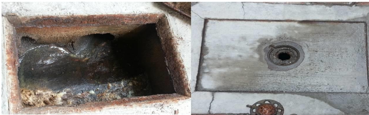
Figura 11. Registro con desechos y cucarachas P. americana , y coladera para aplicación de las nebulizaciones.
