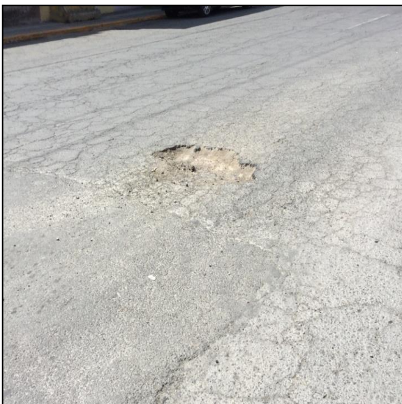
Figura 25 “Calles sin mantenimiento de la colonia”
