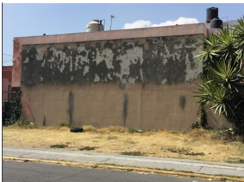
Figura 6 “Vivienda sin mantenimiento en su estructura. Fotografía tomada en la colonia de Los Héroes Ecatepec 3ra sección”
