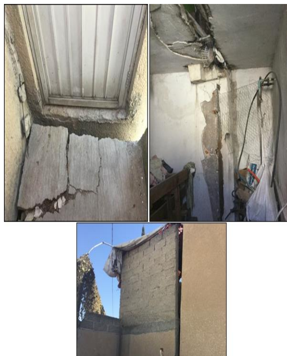
Figura 17 “Ampliación estructural sin cimentación de una vivienda de Los Héroes Ecatepec 3ra Sección”
