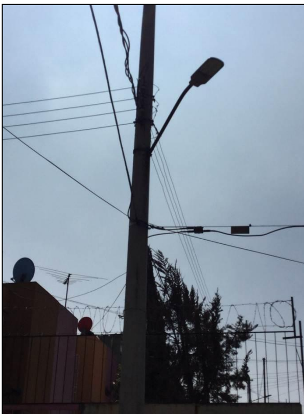
Figura 21 “Servicio de iluminación de las calles de la colonia”
