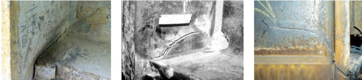
Figura 2.5. Conexiones dañadas tras el sismo de Northridge [3].
