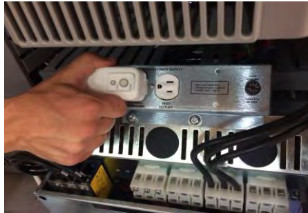
Figura 9. Desconexión del ventilador (Ortega & Soladana. 2018).
