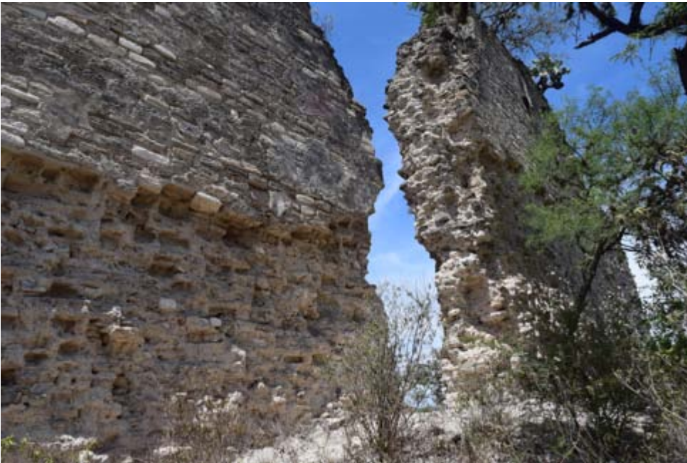
Fig. 20 Desprendimientos del paramento norte del templo de Concepción de nuestra Señora. Foto del autor.
